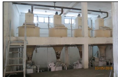
Loji Rawatan Air Sungai Linggi - Mesin Pembancuh Kapur yang Sudah Tidak Digunakan (03.05.2018)
