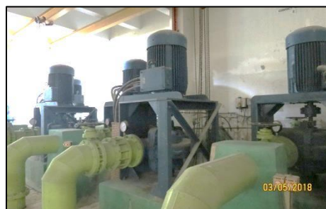
Loji Rawatan Air Sungai Linggi - Pam di Rumah Ozon yang Tidak Dimanfaatkan (03.05.2018)
