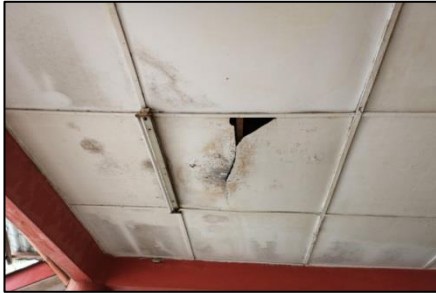
Gerai Taman Desa Rhu, Sikamat - Siling Bumbung yang Pecah dan Hampir Roboh (29.08.2018)
