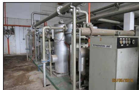
Loji Rawatan Air Sungai Linggi Peralatan di Rumah Ozon yang Sudah Tidak Digunakan (03.05.2018)
