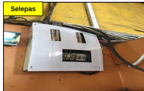
Kios Rangkaian Terminal 1, Seremban - Pendawaian Elektrik yang Telah Dikemaskan (September 2018) (Sumber: MPS)
