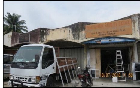
Gerai Batu 2 ½ Jalan Kuala Pilah - Bangunan Kelihatan Uzur, Cat Lama Mengelupas dan Berlumut (18.07.2018)
