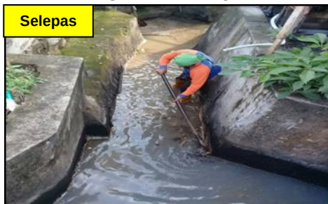
Kios Penjaja e-Kasih - Longkang Tersumbat Telah Dibersihkan (September 2018) (Sumber: MPS)
