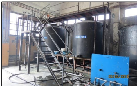
Loji Rawatan Air Sungai Linggi - Tangki Berisi Potassium Permanganate yang Sudah Tidak Digunakan (03.05.2018)
