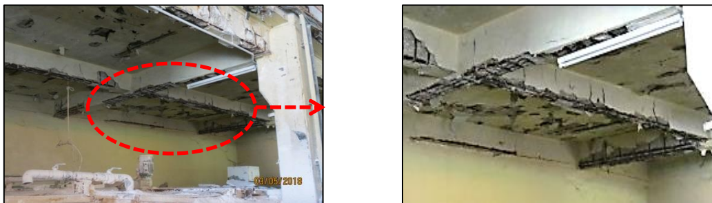
Stor Bahan Kimia, Loji Rawatan Air Sungai Linggi - Keadaan Besi Tetulang di Bahagian Beam Jelas Kelihatan dan Perlu Dibaikpulih (03.05.2018)
