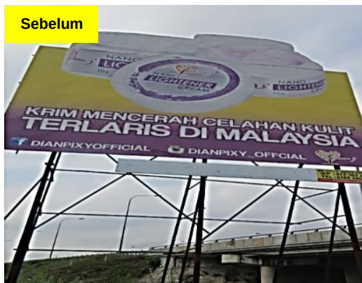
Gambar 1.4 Struktur Papan Iklan Dibina Tanpa Kebenaran Dan Dipamer Tanpa Lesen
