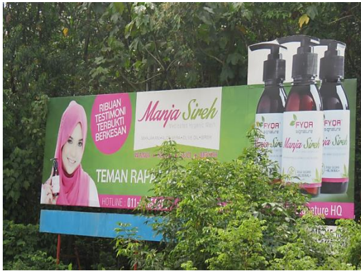
Gambar 1.3 Struktur Papan Iklan Dibina Tanpa Kebenaran Dan Dipamer Tanpa Lesen
