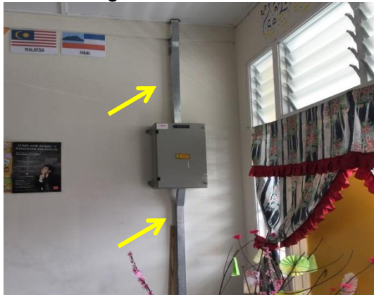
Gambar 2.1 Trunking Tidak Dikod Warna Oren
