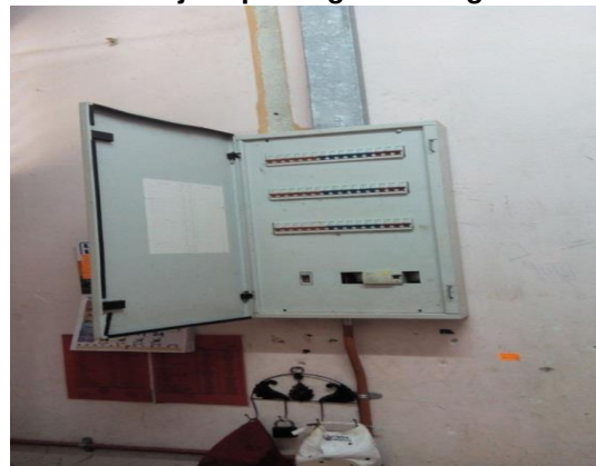
Gambar 2.9 1 DB Sahaja Dipasang Di Ruang Masak
