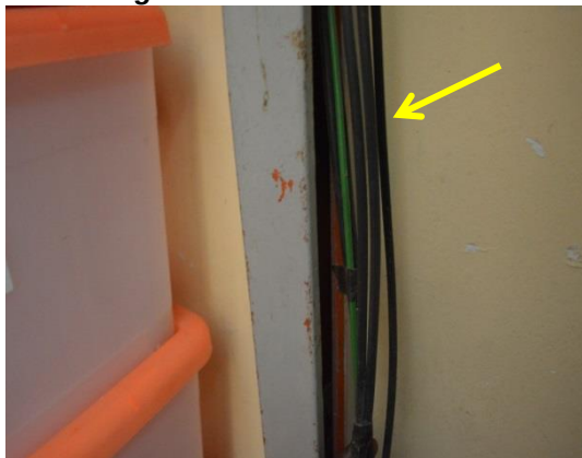
Gambar 2.8 Trunking Dan Kabel Tidak Ditukar Baru
