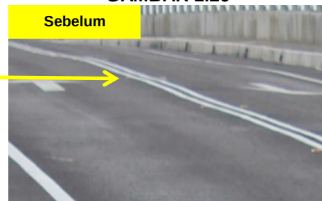
Jambatan Batang Samarahan - Sebahagian Permukaan Jalan di Jambatan Tidak Rata (31.07.2018)
