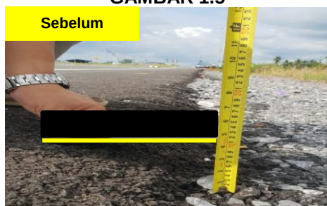
Jambatan Batang Samarahan Chainage 0-380 (Approach Road) - Bahu Jalan ( Unpaved Shoulder ) Rendah Daripada Permukaan Pavement (31.07.2018)
