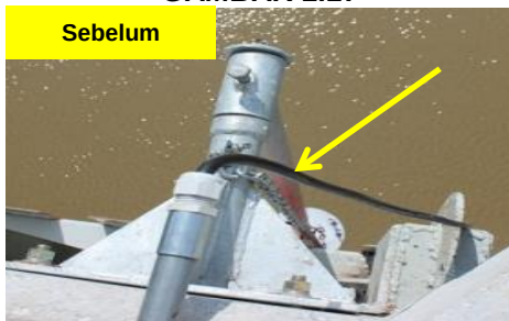
Jambatan Batang Samarahan - Konduit Boleh Lentur Tidak Dipasang Bagi Pendawaian ke Lampu Navigasi dan Lampu Limpah di Span 7 (31.07.2018)
