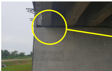
Jambatan Batang Samarahan ( Abutment A ) - Elastomeric Bearing Dipasang Tidak Tepat di Bahagian Tengah T-Beam No. 1 (31.07.2018)
