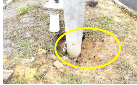
Jalan C1 - Phase 5 Stage 1- Proposed Samalaju Boulevard Package 1 - Tapak Konkrit Tidak Dibina pada Tiang Lampu Jalan yang Telah Ditanam (03.10.2018)
