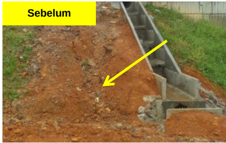
Jambatan Batang Samarahan - Cerun Tidak Dilindungi dan Berlaku Hakisan Tanah (31.07.2018)
