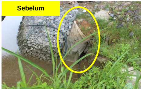
Jambatan Batang Samarahan - Pemasangan River Slope Protection Tidak Kemas (31.07.2018)
