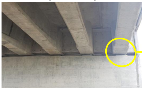
Jambatan Batang Samarahan ( Abutment A ) - Elastomeric Bearing Dipasang Tidak Tepat di Bahagian Tengah T-Beam No. 7 (31.07.2018)
