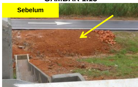
Jambatan Batang Samarahan (Bawah Jambatan) - Spot Turfing Tidak Ditanam di Sebahagian Bahu Jalan (31.07.2018)
