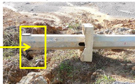
Jalan C1 - Phase 5 Stage 1- Proposed Samalaju Boulevard Package 1 - Tiada Bearing Plate pada Tiang Lampu Jalan yang Ditanam (03.10.2018)
