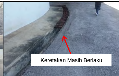
Bangunan Utara Baraj - Keretakan Papak Konkrit Berlaku di Bangunan Utara Baraj (26.07.2017)
