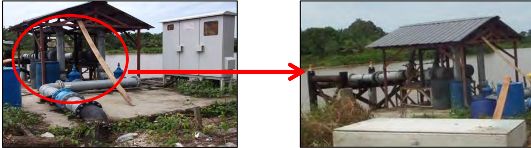
Phase 2 Package 3 Bahagian Mukah, Sarawak - 5 MLD Raw Water Intake di Penakub Jetty Tidak Digunakan (19.07.2017)
