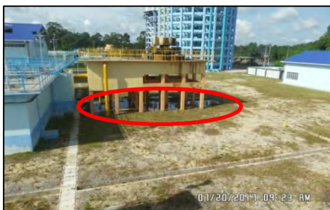
Phase 2 Package 1 Bahagian Mukah, Sarawak - Kesan Limpahan Air di Kompartmen Pengudaraan (20.07.2017)
