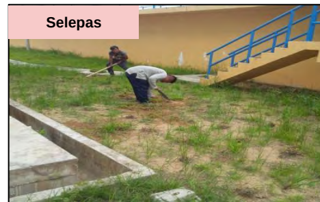
Phase 2 Package 2 Bahagian Mukah, Sarawak - Tindakan Pembaikan Telah Dibuat (26.10.2017) (Sumber: Jabatan Kerja Raya Sarawak)
