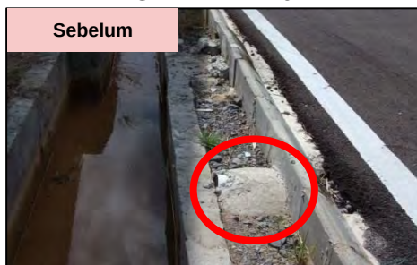
Phase 2 Package 1 Bahagian Mukah, Sarawak - Outlet Untuk Weephole Tidak Disediakan (20.07.2017)
