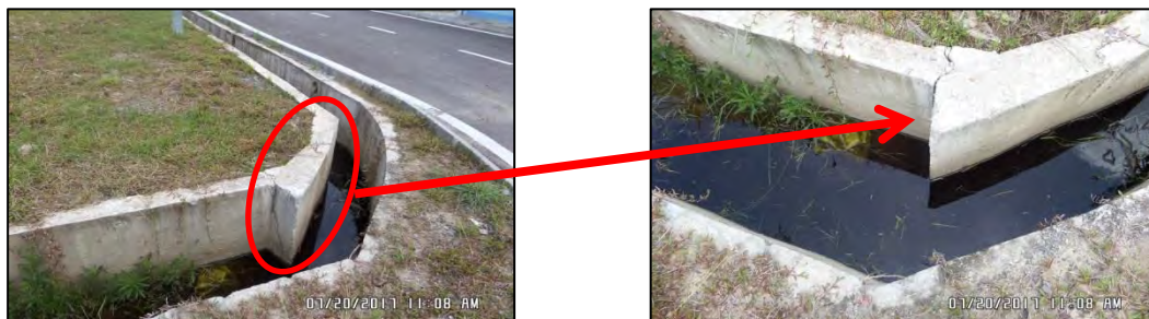
Phase 2 Package 1 Bahagian Mukah, Sarawak - Longkang Tidak Kemas (20.07.2017)
