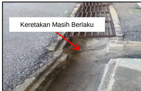
Bangunan Utara Baraj - Keretakan Parit Berlaku di Bangunan Utara Baraj (26.07.2017)
