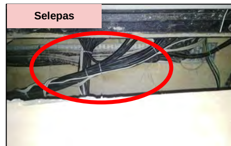
Phase 2 Package 1 Bahagian Mukah, Sarawak - Tindakan Pembaikan Telah Dibuat (14.09.2017) (Sumber: Jabatan Kerja Raya Sarawak)
