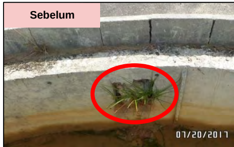
Phase 2 Package 1 Bahagian Mukah, Sarawak - Weephole Jalan Tersumbat Dengan Simen (20.07.2017)
