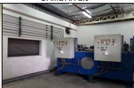
Bangunan Utara Baraj - Bilik Pam Motor (16.10.2017)
