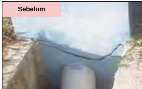
Phase 2 Package 1 Bahagian Mukah, Sarawak - Tiang Retak (20.07.2017)
