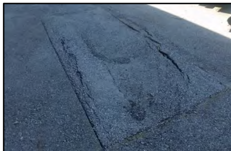
Bangunan Utara Baraj - Pothole Menurun dan Retak (26.07.2017)
