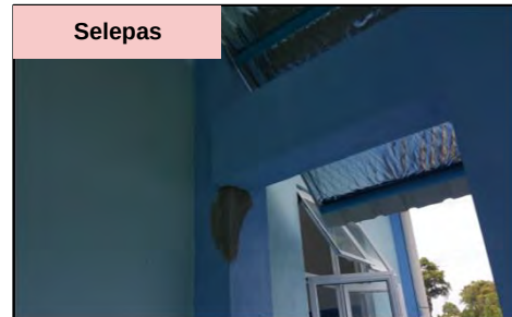
Phase 2 Package 1 Bahagian Mukah, Sarawak - Tindakan Pembaikan Telah Dibuat (14.09.2017) (Sumber: Jabatan Kerja Raya Sarawak)
