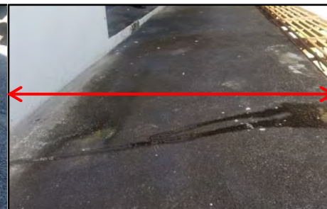
Bangunan Utara Baraj - Bangunan Utara Baraj Kelihatan Menurun (26.07.2017)
