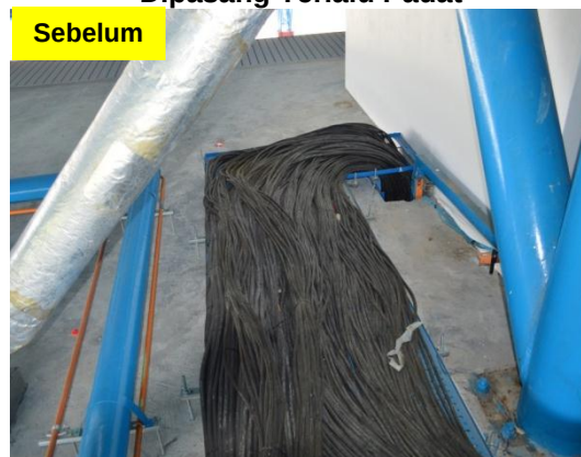
Gambar 2.2 Kabel Elektrik Untuk Lampu Limbah Dipasang Terlalu Padat
