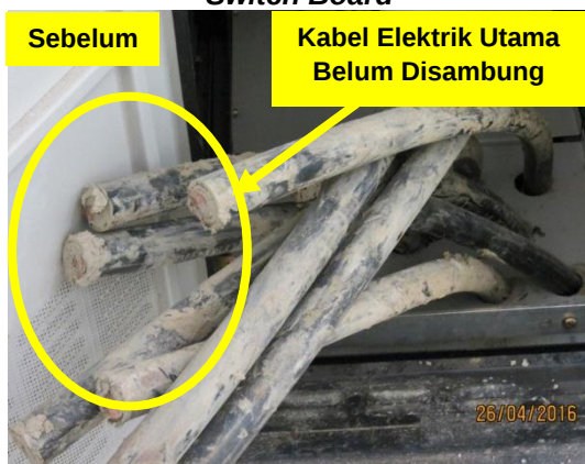
Gambar 2.7 Kabel Elektrik Utama Belum Disambungkan Lagi Pada Main Switch Board
