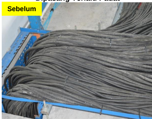
Gambar 2.1 Kabel Elektrik Untuk Lampu Limbah Dipasang Terlalu Padat
