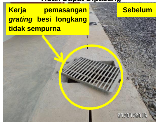
Gambar 2.21 Grating Besi Longkang Tidak Dapat Dipasang
