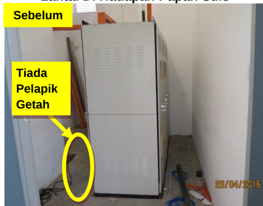
Gambar 2.5 Tiada Pelapik Getah Diletakkan Di Atas Lantai Di Hadapan Papan Suis
