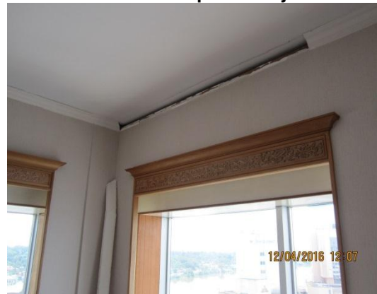
Gambar 4.4 Bilik Out Of Order Disebabkan Kebocoran Apabila Hujan
