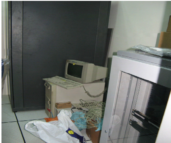
Foto 52 Sampah Yang Tidak Dibersihkan di Bilik Server PDT Port Dickson
