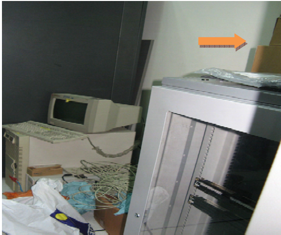
Foto 45 Kotak Di Atas Kabinet Di Bilik Server PDT Port Dickson
