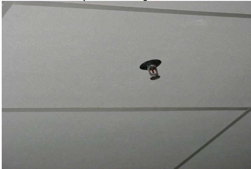
Foto 51 Kemudahan Water Sprinkler Di Siling Bilik Kebal PDT Seremban
