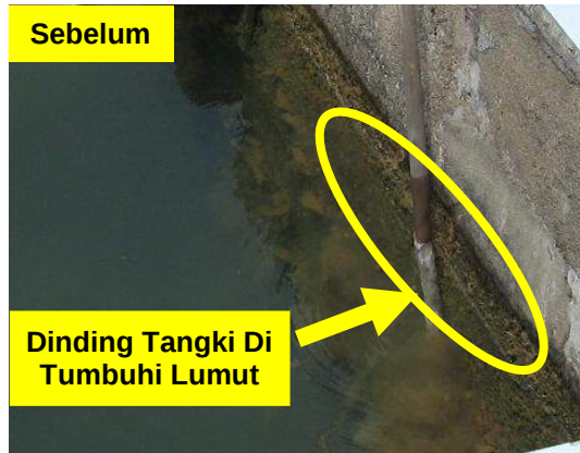
Gambar 1.5 Dinding Tangki Pemendapan Ditumbuhi Lumut
