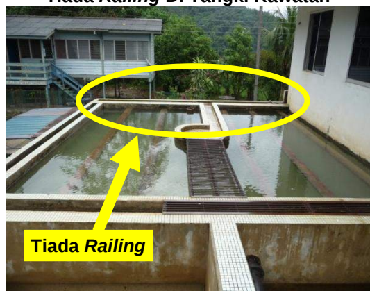
Gambar 1.16 Tiada Railing Di Tangki Rawatan
