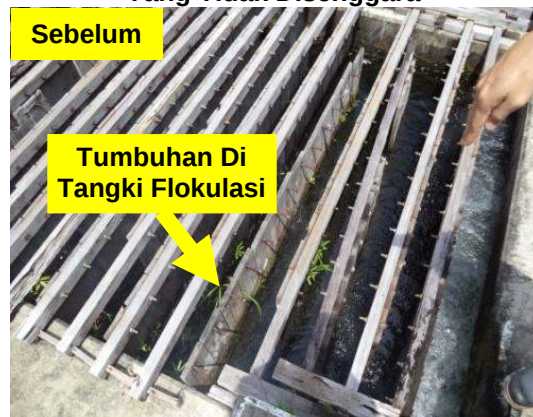
Gambar 1.9 Sesekat ( Baffles ) Di Tangki Flokulasi Yang Tidak Disenggara
