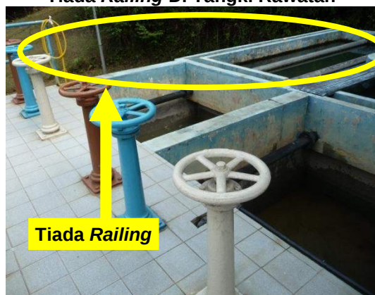
Gambar 1.17 Tiada Railing Di Tangki Rawatan
