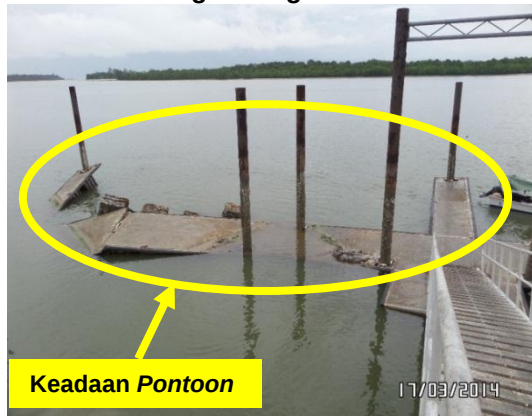
Gambar 2.25 Floating Pontoon Di Tebingan Sungai Yang Runtuh
