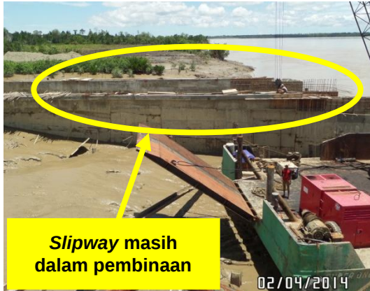
Gambar 2.1 Slipway Yang Masih Belum Siap
