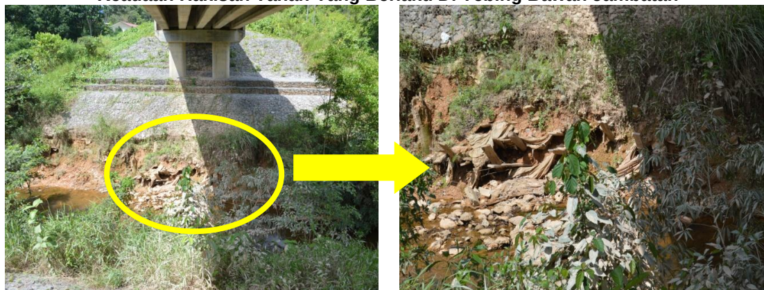
Gambar 3.6 Keadaan Hakisan Tanah Yang Berlaku Di Tebing Bawah Jambatan
