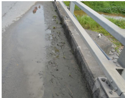
Gambar 3.5 Takungan Air Dan Lumpur Di Tepi Jambatan
