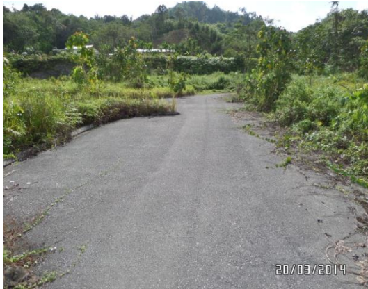
Gambar 2.17 Infrastruktur Service Centre Ditumbuhi Semak Samun
