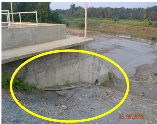
Gambar 2.14 Bawah Struktur Intake Tidak Ditimbus Dengan Tanah
