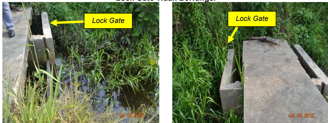
Gambar 2.4 Lock Gate Tidak Berfungsi
