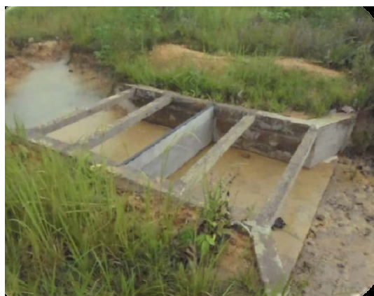
Gambar 2.2 Kedudukan Control Drop A Kurang Berkesan
