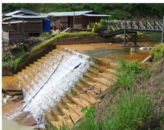
Gambar 2.3 Empangan Sungai Liam Bernilai RM0.29 Juta Tidak Dapat Dimanfaatkan
