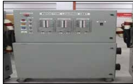
Bengkel Jentera Elektrik, MISDEC - Inductive Loading Unit yang Tidak Digunakan (14.1.2019) (Sumber: Jabatan Audit Negara)
