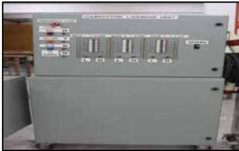
Bengkel Jentera Elektrik, MISDEC - Capacitive Loading Unit yang Tidak Digunakan (14.1.2019) (Sumber: Jabatan Audit Negara)
