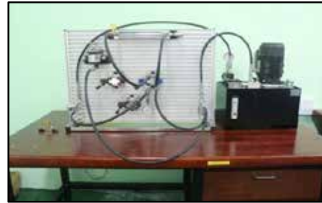
Bengkel Hydraulic, MISDEC - Hydraulic Training Kit (Peralatan Mekanikal) Tidak Digunakan (14.12.2018) (Sumber: Jabatan Audit Negara)
