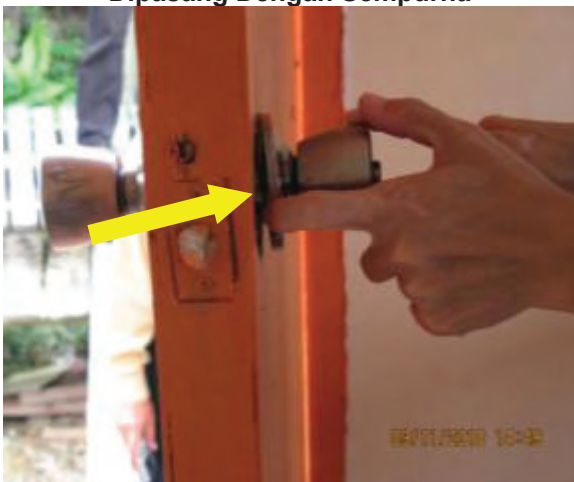
Gambar 2.17 Tombol Pintu Tidak Dipasang Dengan Sempurna
