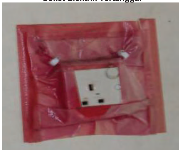
Gambar 8.11 Soket Elektrik Tertanggal
