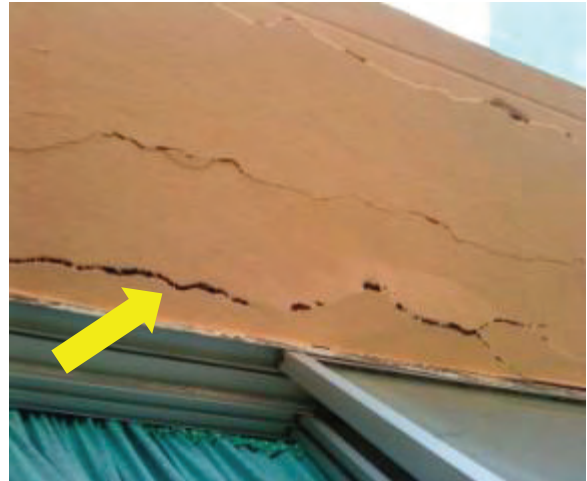
Gambar 8.8 Siling Bangunan Yang Retak
