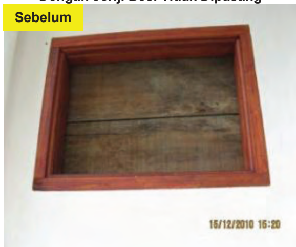
Gambar 2.5 Tingkap Ram Kaca Tetap Dengan Jeriji Besi Tidak Dipasang
