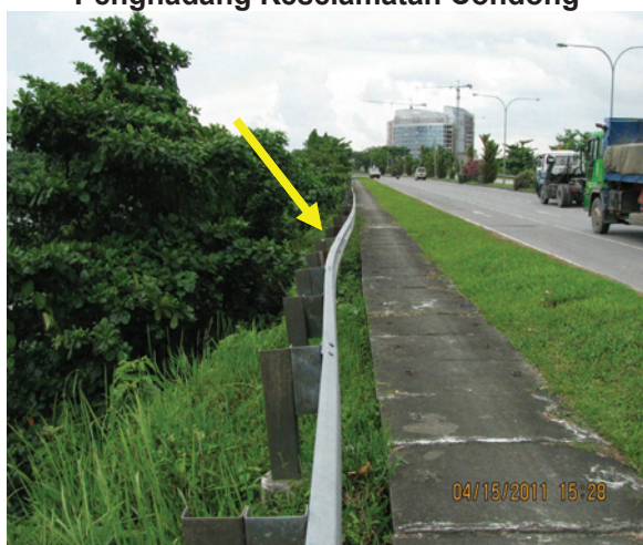
Gambar 10.7 Penghadang Keselamatan Condong
