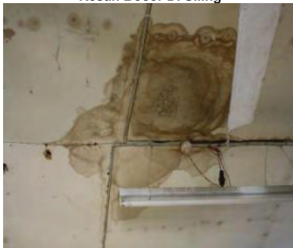
Gambar 8.18 Kesan Bocor Di Siling
