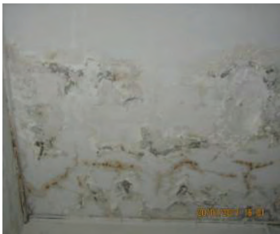
Gambar 8.19 Cat Siling Mengelupas Disebabkan Bocor
