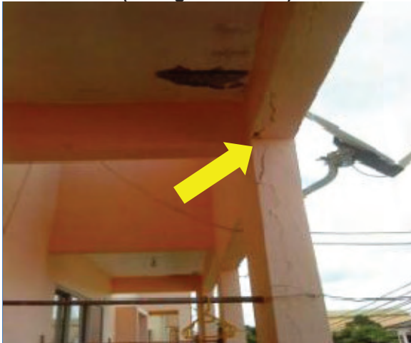
Gambar 8.7 Tiang Bangunan Yang Retak (Bahagian Balkoni)
