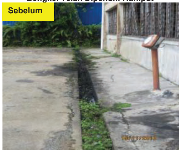
Gambar 5.7 Longkang Di Sekeliling Bangunan Bengkel Telah Dipenuhi Rumput
