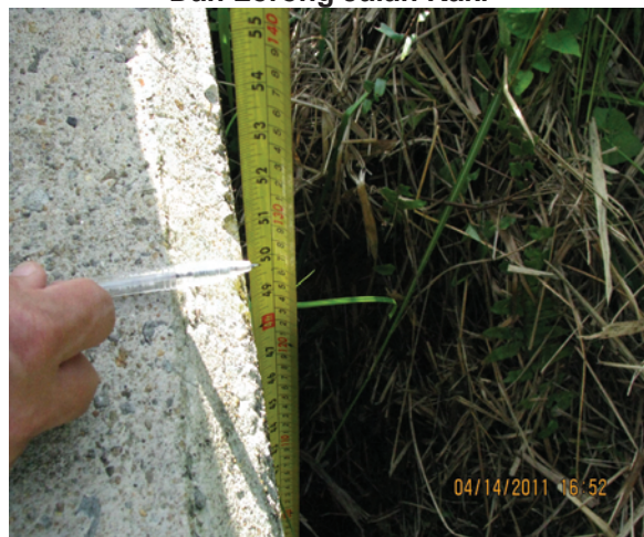
Gambar 10.12 Sinkholes Di Antara Sheet Pile Dan Lorong Jalan Kaki
