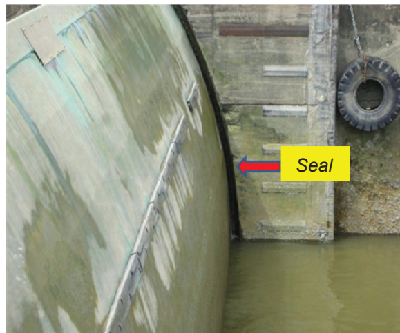
Gambar 10.14 Seal Pintu Shiplock Bocor Tidak Dibaiki
