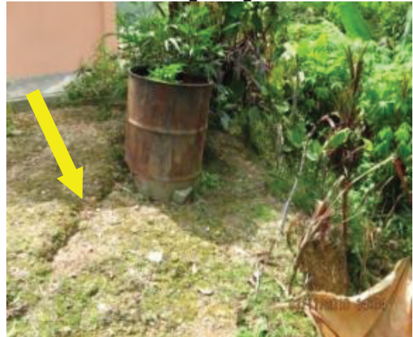
Gambar 2.29 Rekahan Tanah Di Kawasan Rumah Penerima PBR Yang Mengalami Keretakan
