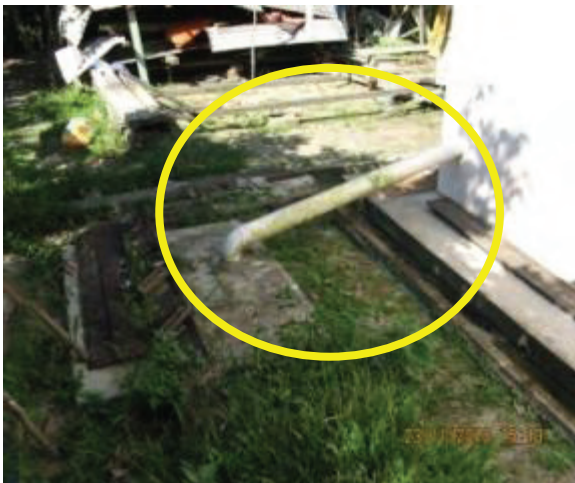
Gambar 2.9 Saluran Tangki Septik Tidak Ditanam Ke Dalam Tanah
