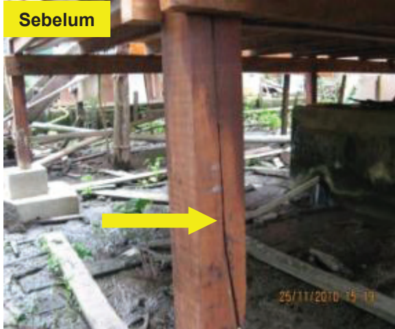
Gambar 2.11 Tiang Rumah Retak
