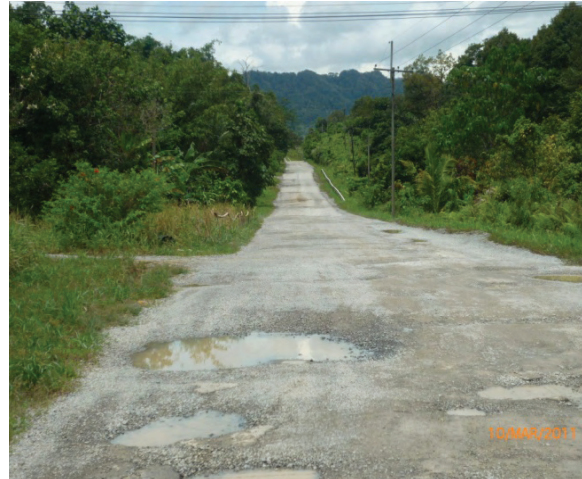
Gambar 3.15 Keadaan Jalan Bengoh/Danu Pada Bulan Mac 2011
