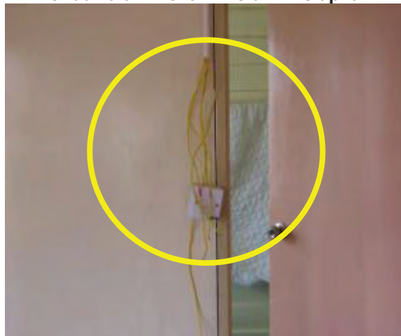
Gambar 2.25 Pendawaian Elektrik Belum Disiapkan
