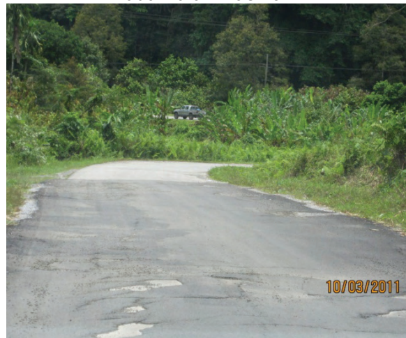
Gambar 3.17 Keadaan Jalan Bengoh/Danu Pada Bulan Mac 2011
