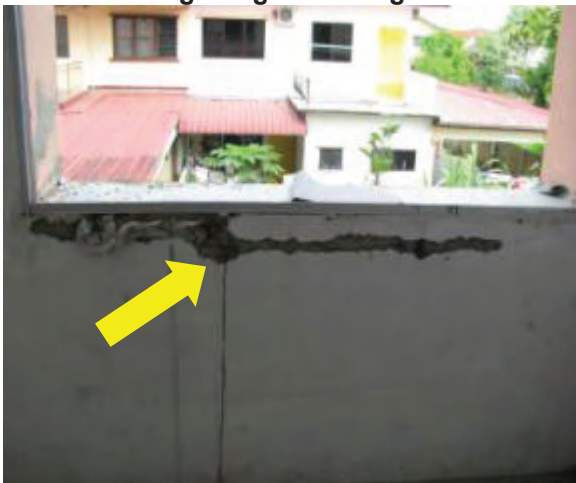
Gambar 8.9 Dinding Bangunan Yang Retak
