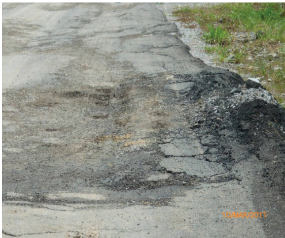
Gambar 3.16 Keadaan Jalan Bengoh/Danu Pada Bulan Mac 2011
