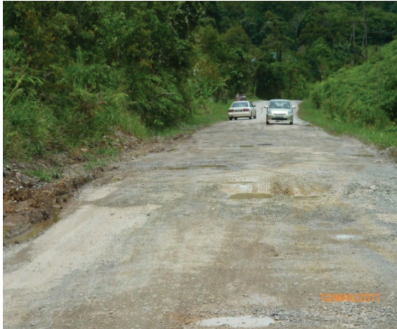
Gambar 3.14 Keadaan Jalan Bengoh/Danu Pada Bulan Mac 2011
