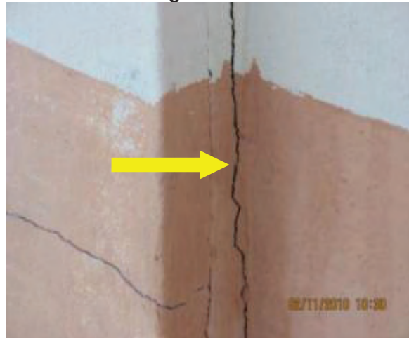
Gambar 2.16 Dinding Rumah Retak
