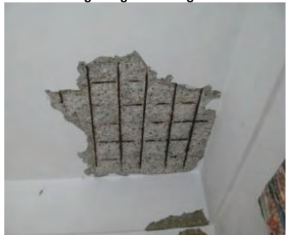
Gambar 8.10 Siling Bangunan Yang Retak
