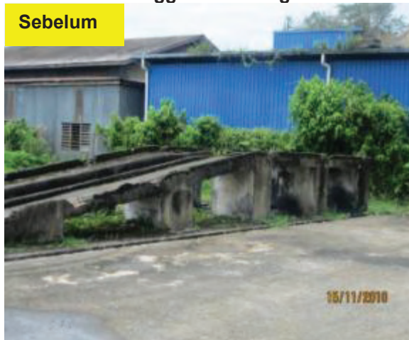
Gambar 5.5 Repair Bridge Tidak Disenggarakan Dengan Baik
