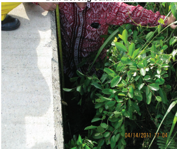
Gambar 10.11 Sinkholes Di Antara Sheet Pile Dan Lorong Jalan Kaki
