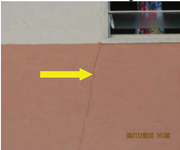
Gambar 2.30 Keadaan Dinding Luar Rumah Penerima PBR Yang Retak
