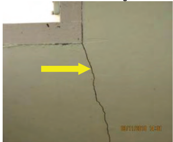
Gambar 2.31 Keadaan Dinding Bilik Tidur Rumah Penerima PBR Yang Retak
