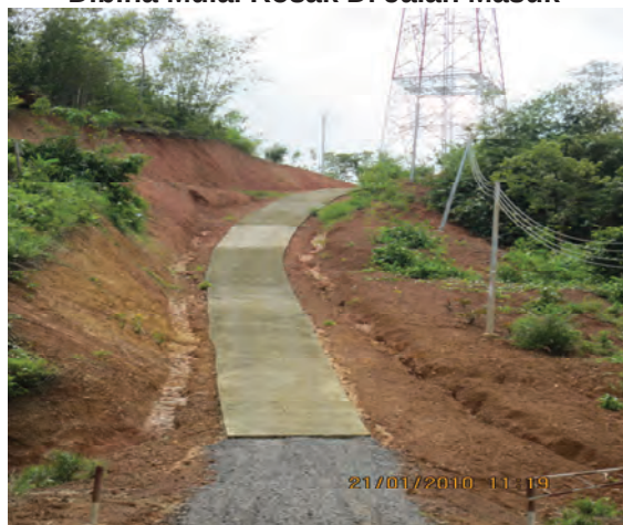
Foto 13.7 Longkang Tanah Yang Dibina Mulai Rosak Di Jalan Masuk
