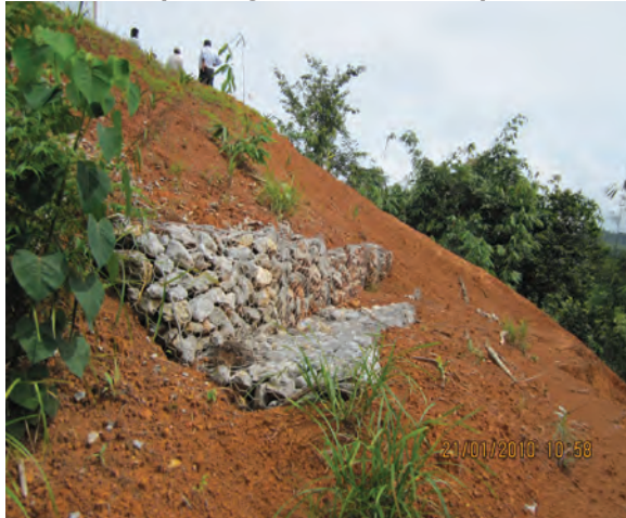
Foto 13.5 Rumput Ditanam Dan Gabion Dipasang Tidak Mencukupi
