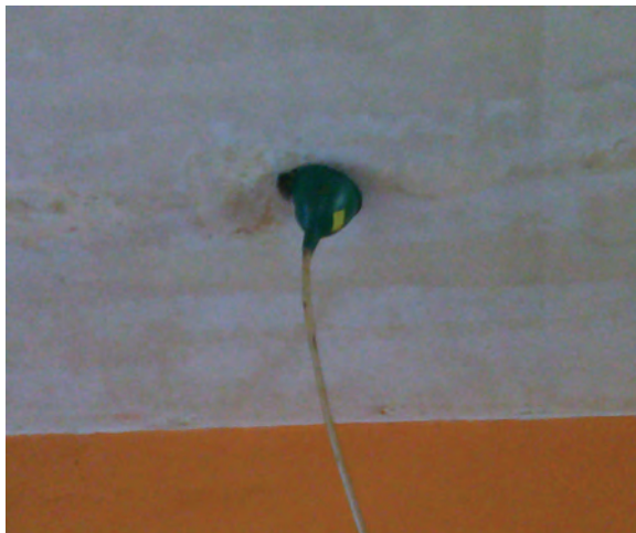
Foto 10.18 Corong Digunakan Untuk Menyalurkan Air Dari Kebocoran Di Tingkat Atas
