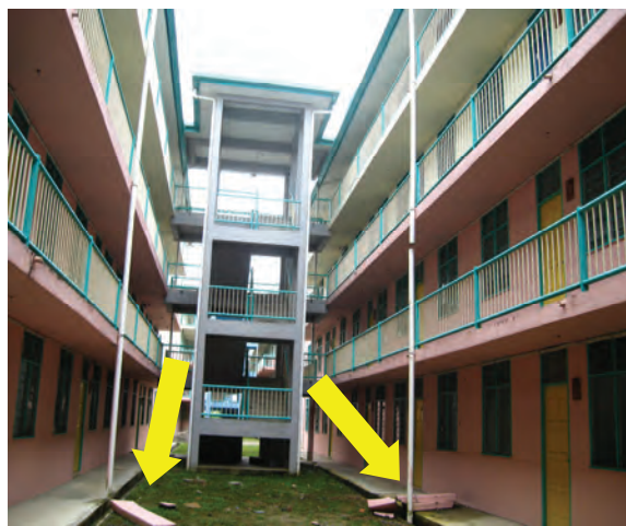
Foto 10.3 Tiang Penyokong Telah Jatuh
