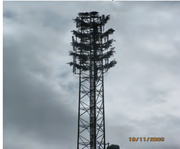
Foto 13.2 Menara Jenis Monopole Tree
