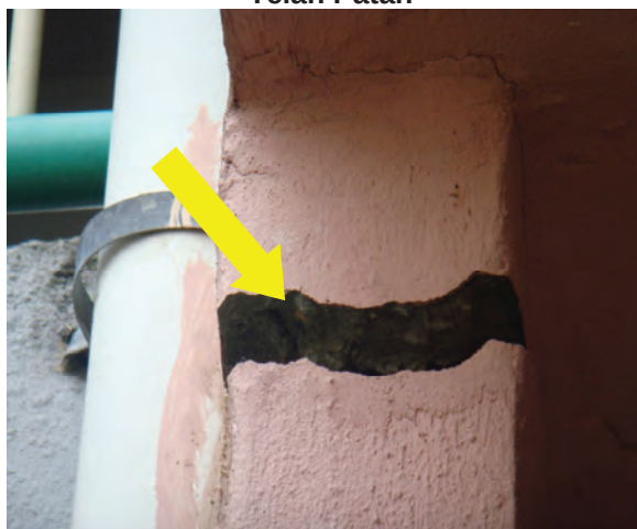
Foto 10.2 Tiang Penyokong Saluran Tegak Air Hujan Telah Patah
