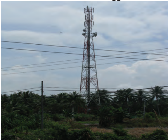
Foto 13.3 Menara Jenis 3 - Legged
