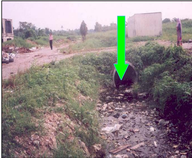
Foto 86 Parit Tersumbat Akibat Buangan Sampah Dari Tapak Pelupusan Matang
