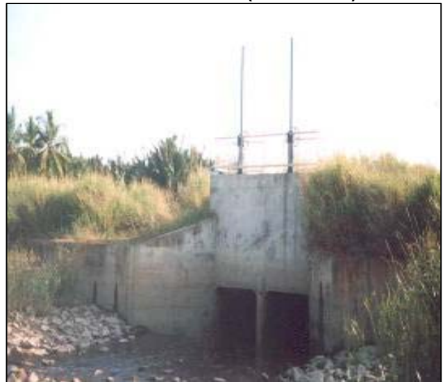
Foto 46 Semak-Samun Di Sekitar Pintu Kawalan Air (Tidal Gate)
