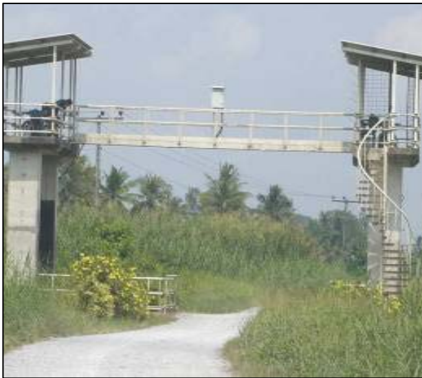
Foto 45 Rumput Yang Tinggi Di Sekitar Pintu Kawalan Air Berkembar
