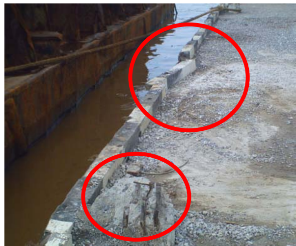
Foto 68 Bollard Dan Kerb Yang Rosak
