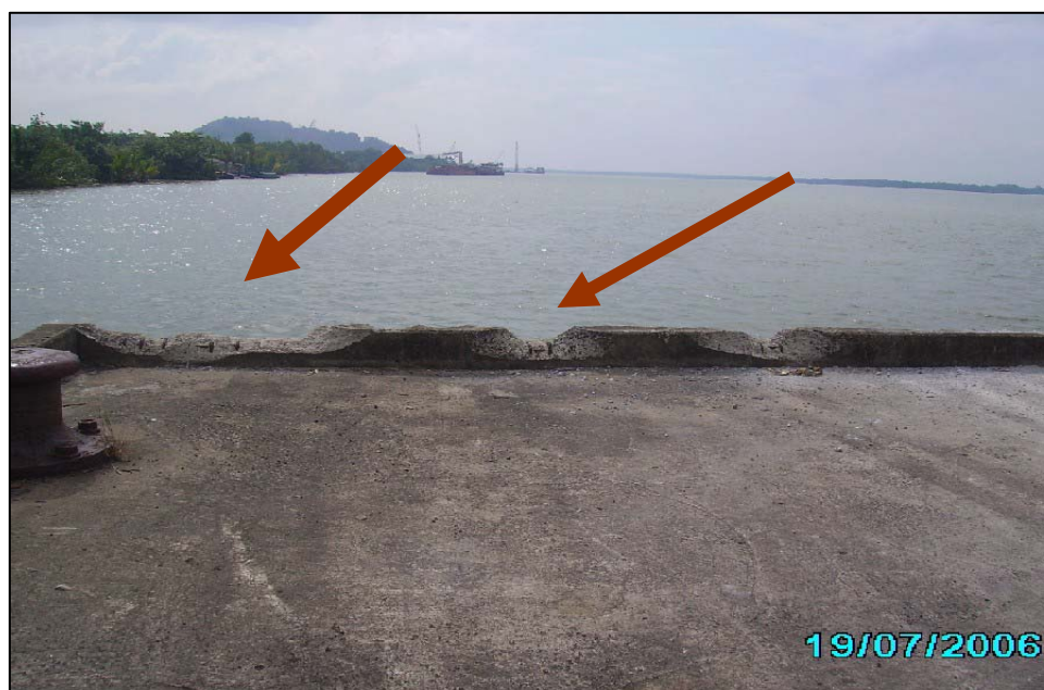
Foto 69 Kerb Pecah Yang Tidak Dibaiki Boleh Menyebabkan Kerosakan Bertambah
