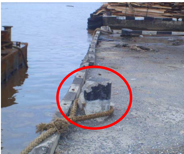
Foto 67 Bollard Dan Kerb Yang Sudah Rosak
