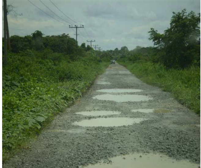
Foto 40 Jalan Yang Berlubang-lubang
