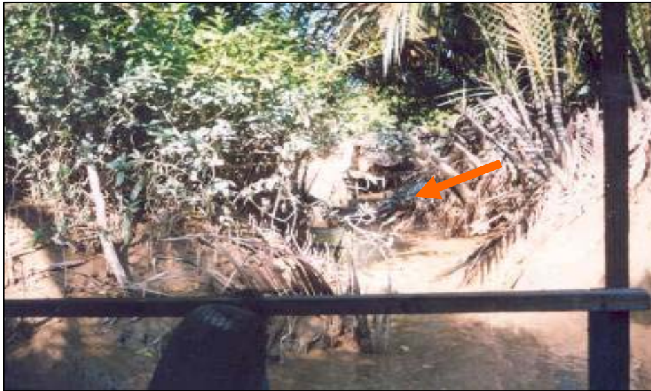
Foto 47 Pintu Kawalan Air Flap Gate Hampir Tidak Kelihatan
