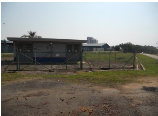
Gambar 1.5 Rumah Pencawang Elektrik
