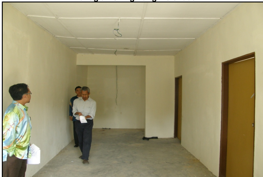
Foto 21 Bahagian Siling Yang Melendut
