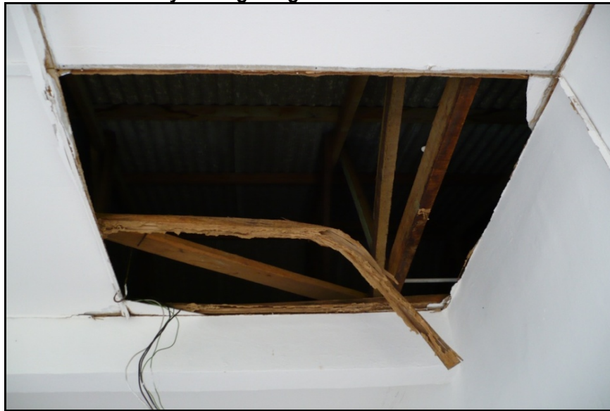
Foto 13 Kayu Siling Yang Dimakan Anai-Anai
