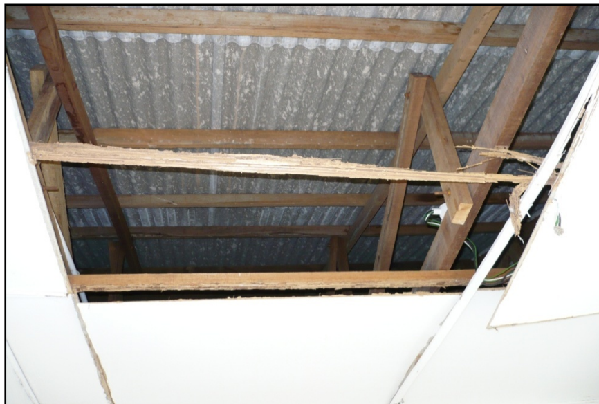
Foto 14 Kayu Siling Yang Dimakan Anai-anai
