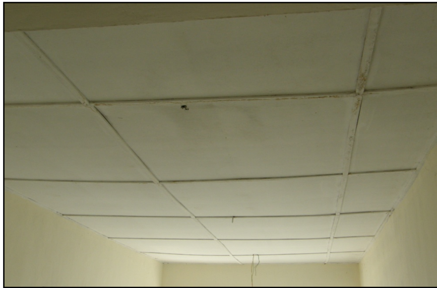
Foto 22 Bahagian Siling Yang Melendut
