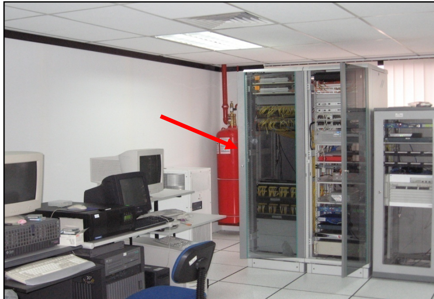
Foto 4 Alat Pemadam Kebakaran Dalam Bilik Server PTG Yang Tiada Penyelenggaraan
