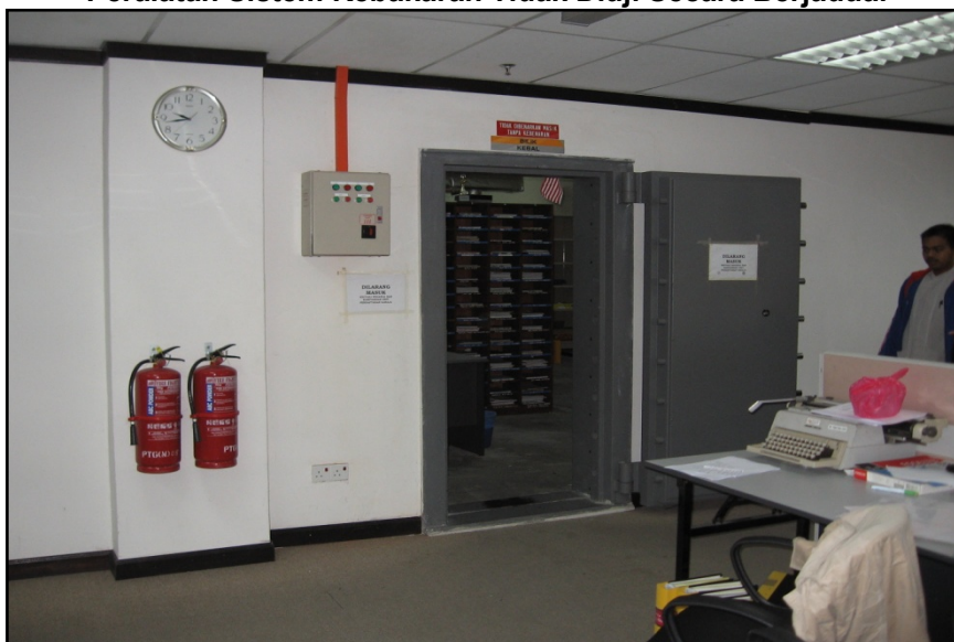
Foto 8 Peralatan Sistem Kebakaran Tidak Diuji Secara Berjadual
