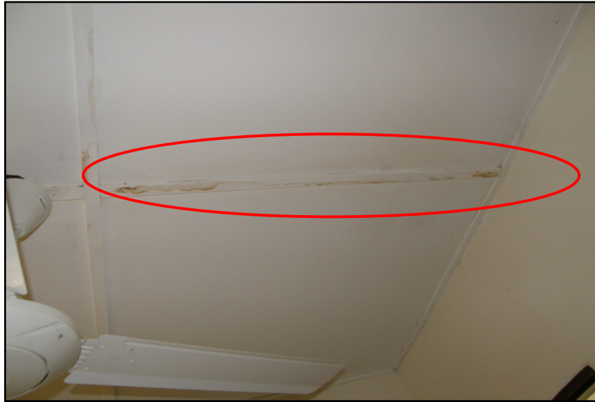
Foto 16 Kesan Air Pada Siling Akibat Daripada Kebocoran Bumbung
