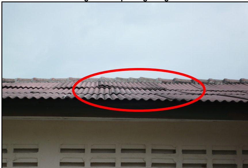
Foto 15 Perabung Tidak Dipasang Dengan Betul
