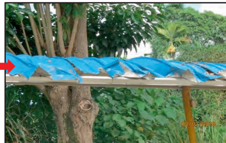
Laluan Pejalan Kaki, Pekan Ranau - Kerosakan Bumbung Belum Diperbaiki (08.01.2018)
