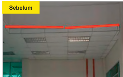
Courtyard, MAN Keningau - Levelling Slab Tidak Selari (11.01.2018)
