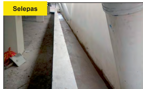
Ruang Atap, MAN Penampang - Lantai Telah Dibaiki (Sumber: JKR)
