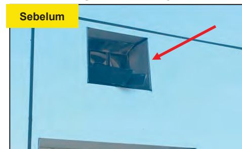
Tandas Aras Bawah, MAN Keningau - Exhaust Fan Shutter Patah (11.01.2018)
