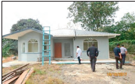
Kuarters Majlis Daerah Ranau - Kerja Pembinaan Belum Siap Sepenuhnya (05.07.2017)
