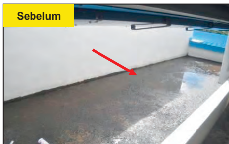
Ruang Atap, MAN Keningau - Lantai Tidak Dibina Dengan Kecerunan yang Sesuai Menyebabkan Air Bertakung (11.01.2018)
