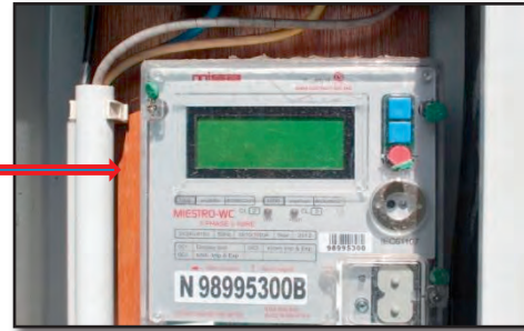
Link Tawau – Kongsı 10, Kg. Jawa - Bekalan Elektrik Telah Dipotong (10.01.2018)
