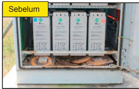
Link Kunak – Kg. Lormalong - Leg B Kg. Lormalong Tidak Dibersihkan Semasa Pemeriksaan Audit (09.01.2018)
