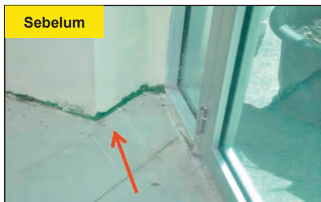
Pintu Utama, MAN Kudat - Bahagian Bawah Dinding Telah Berlumut Kerana Dimasuki Air (15.11.2017)
