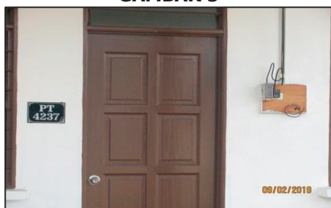
PT 4237, RMMK Taman Wadi Iman Fasa 3A Kok Lanas - RMMK Belum Diduduki Berdasarkan Meter Elektrik Belum Dipasang (9.2.2019)
