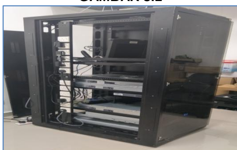
Pejabat IICSB -Rak Server yang Masih Dalam Keadaan Baik Tetapi Tidak Digunakan IICSB (12.08.2018)
