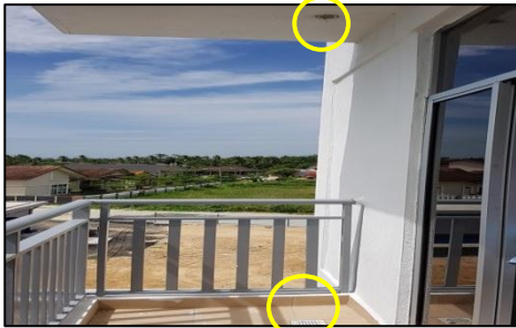
Pangsapuri Kwarters Kerajaan -Tiada Rainwater Downpipe (RWDP) Pada Balkoni (2.8.2018)
