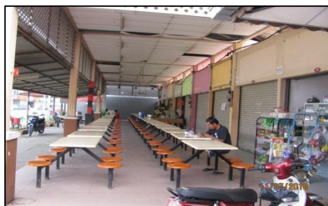
Gerai Pelbagai -Siling yang Rosak Tidak Diperbaiki 11.7.2018
