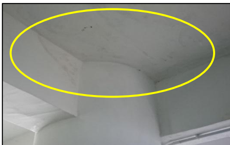
Kompleks Masjid -Terdapat Resapan Air Pada Siling Berhampiran Kubah Masjid (2.8.2018)
