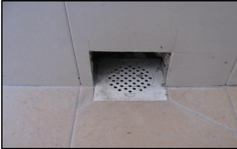
Tandas Kompleks Pasar Awam -Kedudukan Perangkap Lantai yang Tidak Sesuai (2.8.2018)
