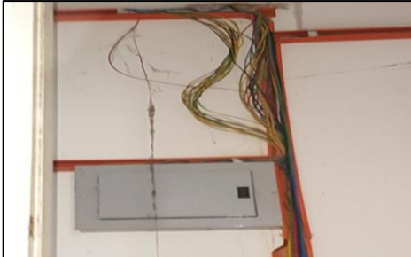
Bilik Servis Elektrik, Pondok Moden -Pemasangan Kabel dan Trunking yang Tidak Kemas dan Cermat. (2.8.2018)
