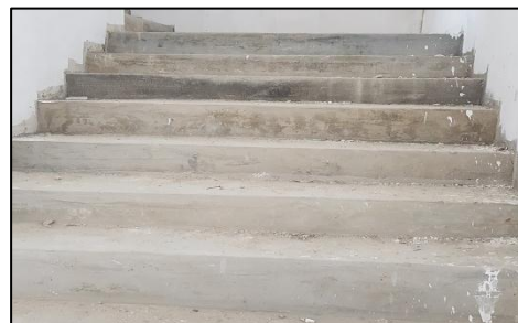
Tangga di Kompleks Pasar Awam -Ketinggian Anak Tangga Tidak Sama (2.8.2018)
