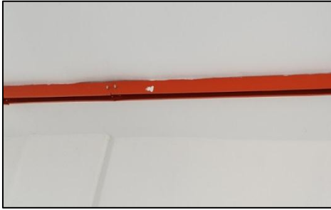
Ruang Lobi Pangsapuri Kwarters Kerajaan -Pemasangan Trunking Tidak Menggunakan Fixing Brackets . (2.8.2018)
