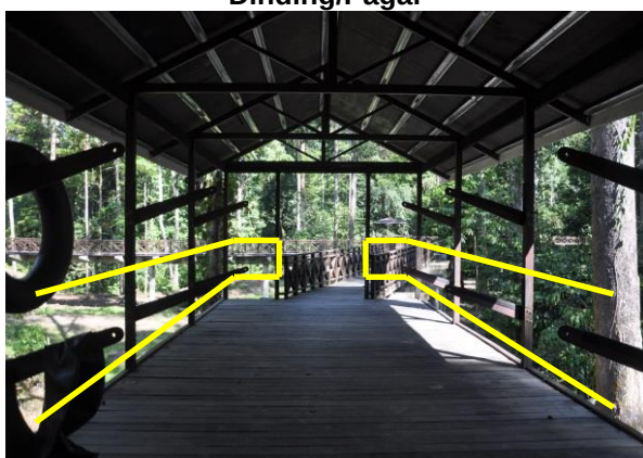
Gambar 7.56 Canoe Storage Tidak Mempunyai Dinding/Pagar
