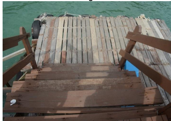
Gambar 5.8 Pemasangan Tangga Dan Lantai Yang Tidak Kemas
