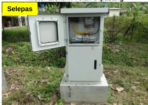
Gambar 8.2 Meter Elektrik Telah Dipasang
