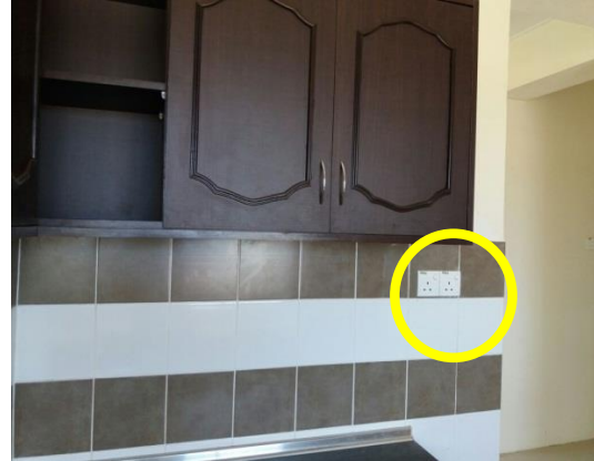
Gambar 1.4 Soket Elektrik Telah Dipasang
