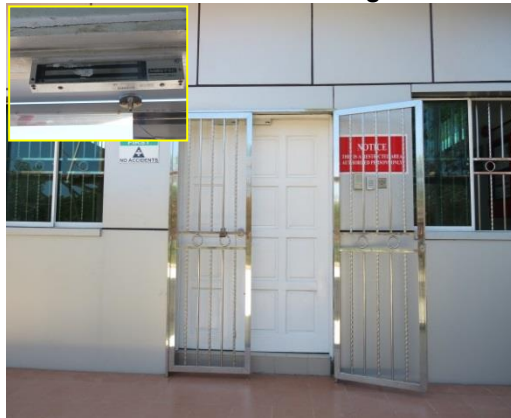
Gambar 1.13 Pintu Masuk Tingkat Bawah Menara Sistem Permonitoran Yang Rosak
