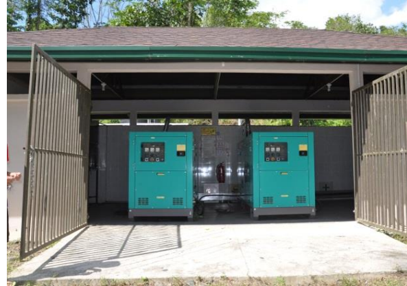
Gambar 7.23 Genset Yang Dipasang Di Bin Centre
