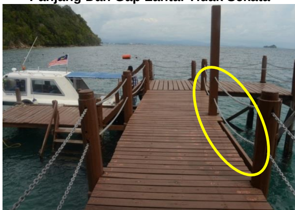
Gambar 5.3 Panjang Dan Gap Lantai Tidak Sekata
