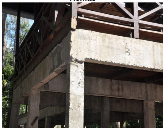
Gambar 7.11 Kerja Menyimen Tiang Dan Beam Tidak Kemas
