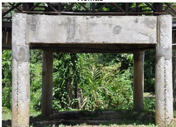
Gambar 7.12 Kerja Menyimen Tiang Dan Beam Tidak Kemas
