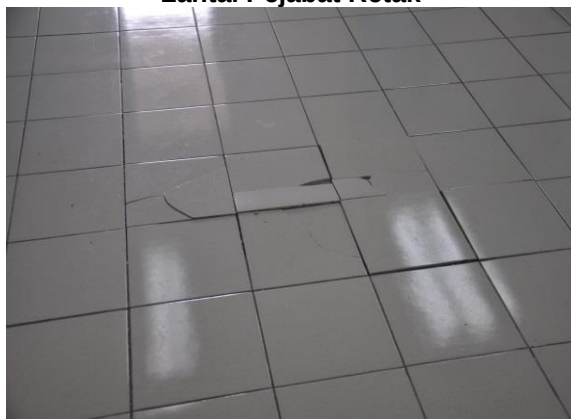
Gambar 7.51 Lantai Pejabat Retak
