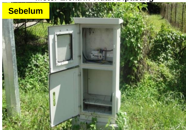
Gambar 8.1 Meter Elektrik Tidak Dipasang
