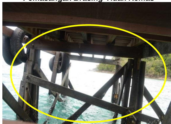
Gambar 5.2 Pemasangan Bracing Tidak Kemas
