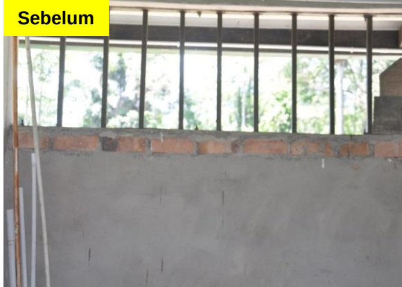
Gambar 7.3 Dinding Genset Room Tidak Disimen Kemas
