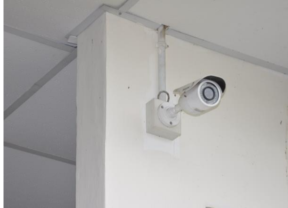
Gambar 7.54 CCTV Tidak Berfungsi
