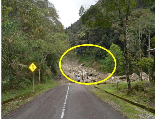
Gambar 5.13 Jalan Utama Rosak Dan Terputus
