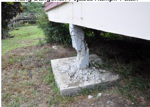
Gambar 7.49 Tiang Bangunan Pejabat Hampir Patah
