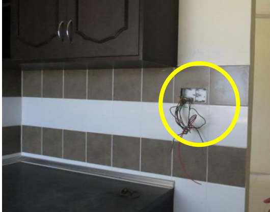
Gambar 1.3 Soket Elektrik Belum Dipasang
