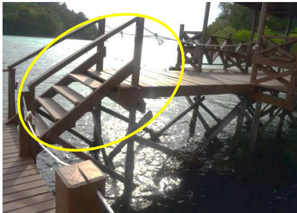
Gambar 5.7 Pemasangan Tangga Dan Handrail Tidak Kemas
