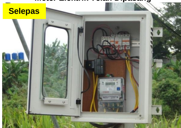
Gambar 8.6 Meter Elektrik Telah Dipasang
