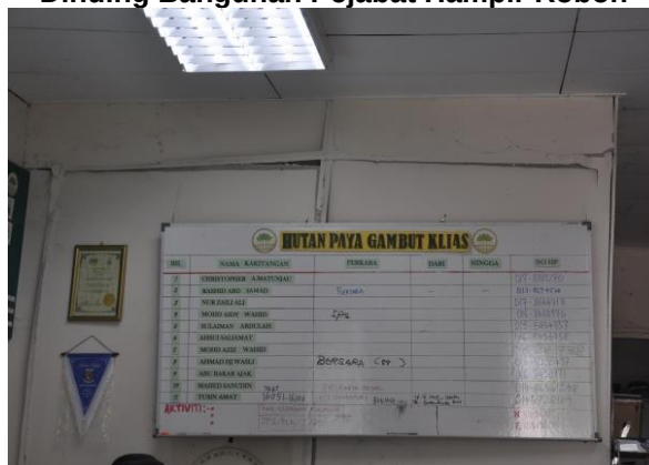
Gambar 7.50 Dinding Bangunan Pejabat Hampir Roboh
