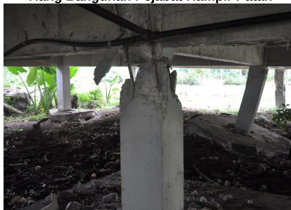
Gambar 7.48 Tiang Bangunan Pejabat Hampir Patah
