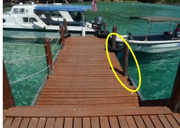
Gambar 5.6 Gap Lantai Tidak Sekata
