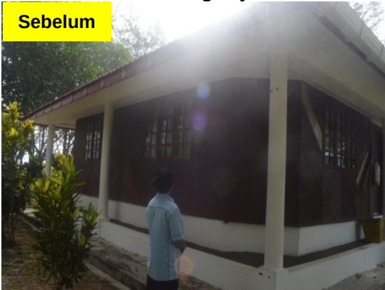
Gambar 5.23 Gutter dan Dinding Pejabat Rosak
