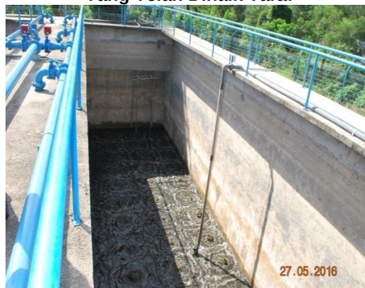
Gambar 2.4 Sewerage Treatment Plant Yang Telah Dinaik Taraf
