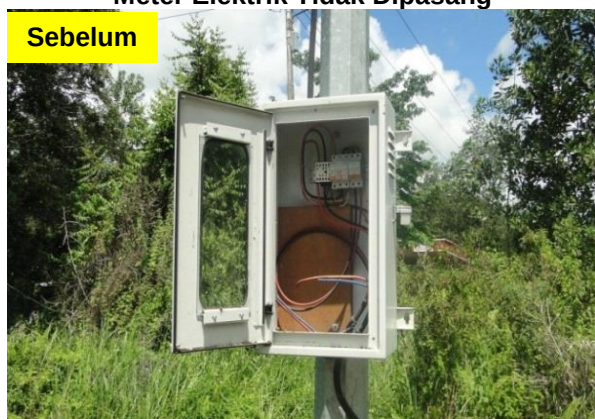
Gambar 8.3 Meter Elektrik Tidak Dipasang
