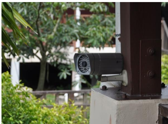
Gambar 7.55 CCTV Tidak Berfungsi
