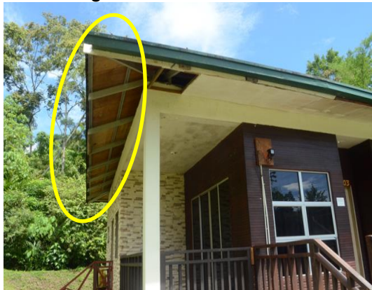
Gambar 5.17 Siling Dan Gutter Chalet Rosak
