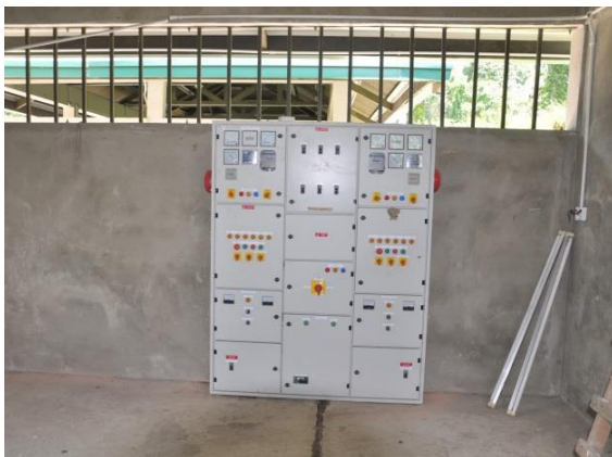
Gambar 7.24 Switchboard Yang Tidak Digunakan Di Bilik Genset
