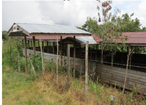
Gambar 6.27 Kandang Kambing Usang Dan Tidak Disenggara Dengan Baik
