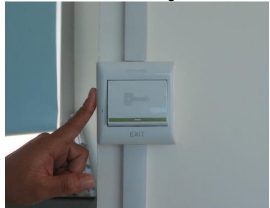
Gambar 1.14 Suis Kawalan Pintu Di Tingkat 5 yang Tidak Berfungsi
