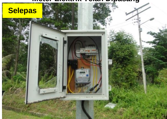
Gambar 8.4 Meter Elektrik Telah Dipasang
