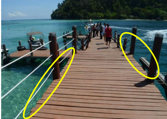
Gambar 5.5 Panjang Dan Gap Lantai Tidak Sekata
