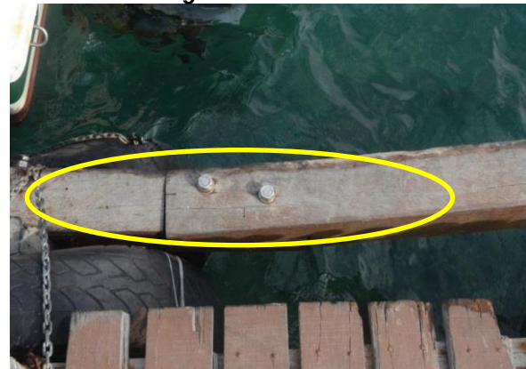
Gambar 5.10 Pemasangan Fender Tidak Kemas
