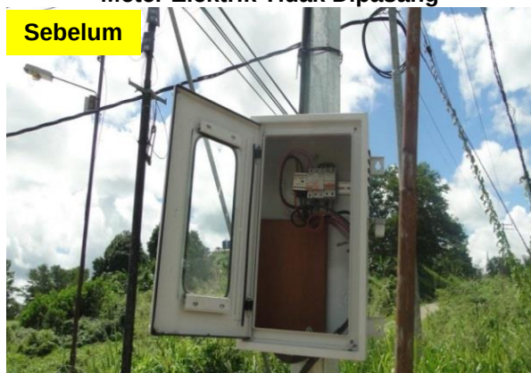
Gambar 8.5 Meter Elektrik Tidak Dipasang
