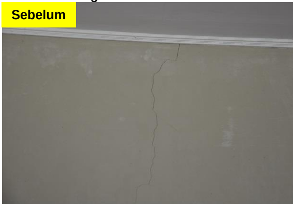
Gambar 7.31 Dinding Tandas Restoran Retak
