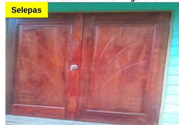
Gambar 7.34 Pintu Genset Room Telah Digantikan
