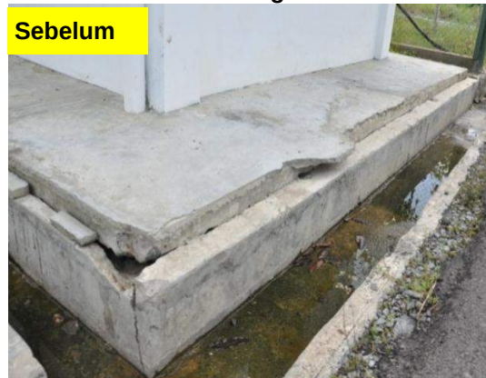
Gambar 3.14 Lantai Dan Tebing Parit Retak
