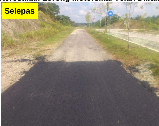
Gambar 3.4 Kerosakan Lorong Motorsikal Telah Dibaiki
