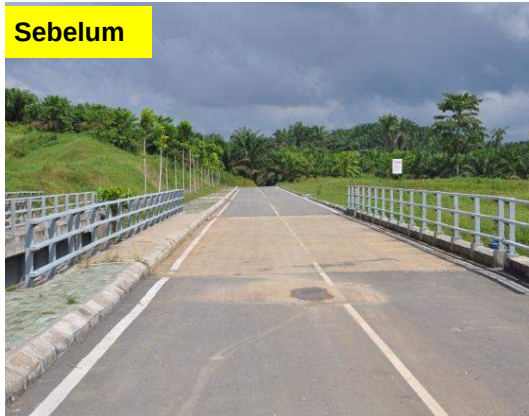
Gambar 3.26 Hard Stand Guardrail Tidak Dicat Hitam Putih
