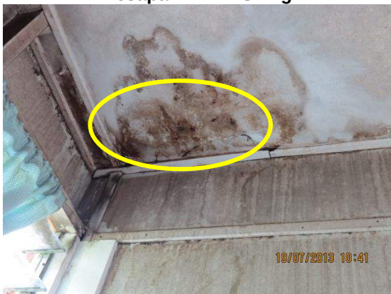
Gambar 1.15 Resapan Air Di Siling
