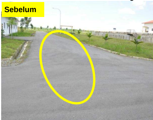
Gambar 3.34 Jalan STP Tiada Road Marking
