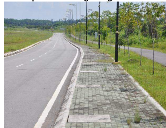
Gambar 3.31 Penutup Saliran Yang Menggunakan Simen
