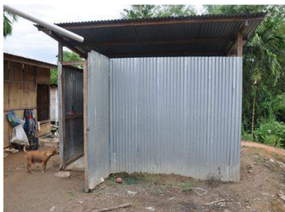
Gambar 2.16 Tingkap Tidak Dibekal dan Di Pasang
