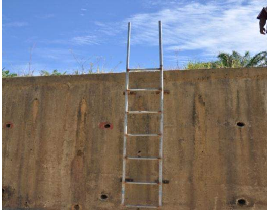
Gambar 3.32 Tangga Yang Dipasang Tidak Mengikut Spesifikasi Seperti Gambar 3.33
