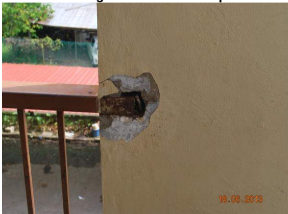
Gambar 1.13 Pemasangan Bar Tidak Sempurna
