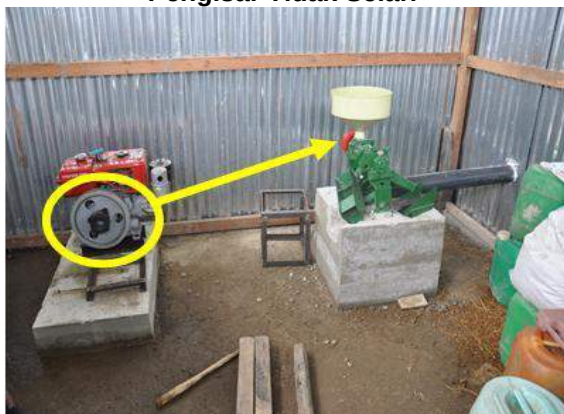
Gambar 2.22 Tapak Pemasangan Belting Mesin Pengisar Tidak Selari
