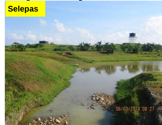
Gambar 3.21 Tebing Pond B Yang Runtuh Telah Dibaiki
