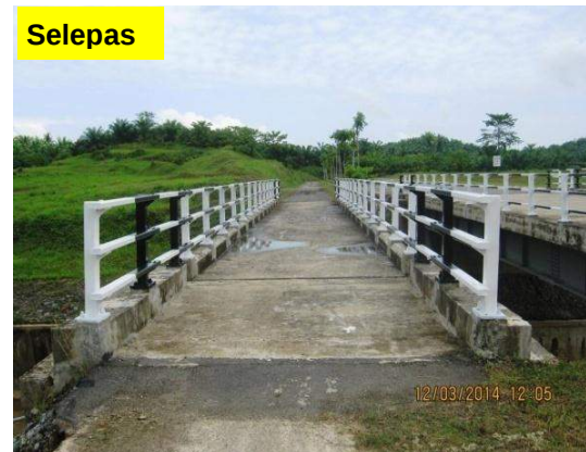
Gambar 3.29 Hard Stand Guardrail Tidak Dicat Hitam Putih
