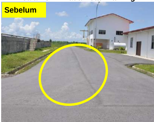
Gambar 3.36 Jalan STP Tiada Road Marking
