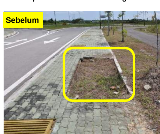
Gambar 3.5 Walkpath – Paver Block Yang Rosak
