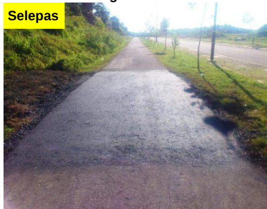
Gambar 3.2 Kerosakan Lorong Motorsikal Telah Dibaiki
