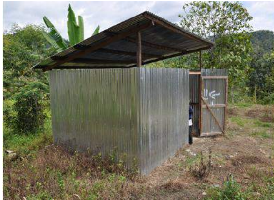
Gambar 2.21 Tingkap Tidak Dibekal dan Di Pasang
