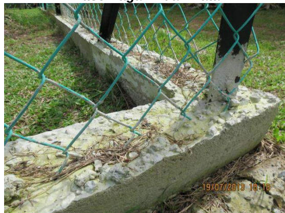
Gambar 1.16 Base Pagar Tidak Rata
