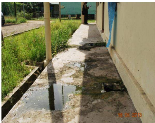
Gambar 1.27 Kebocoran Tandas Dan Saluran Kumbahan
