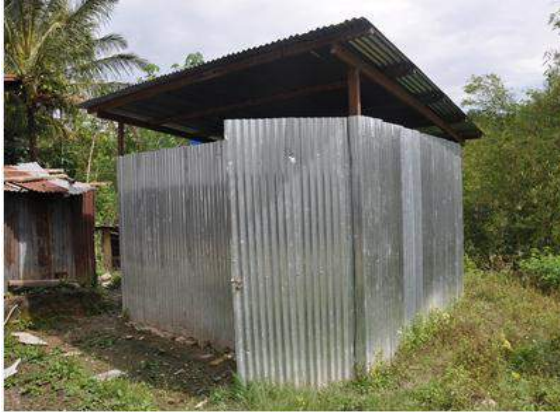
Gambar 2.18 Tingkap Tidak Dibekal dan Di Pasang
