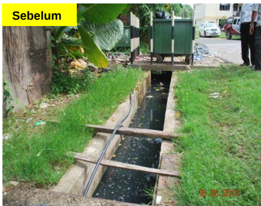
Gambar 1.29 Air Di Longkang Tidak Mengalir
