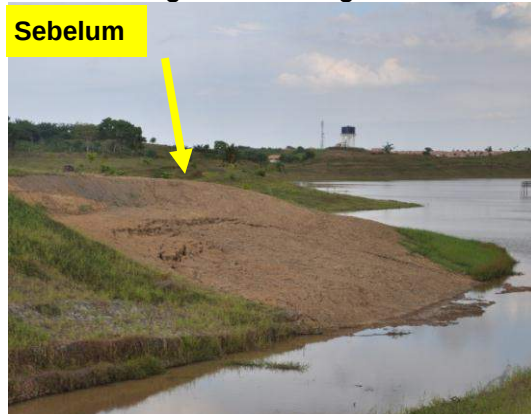
Gambar 3.20 Tebing Pond B Yang Runtuh
