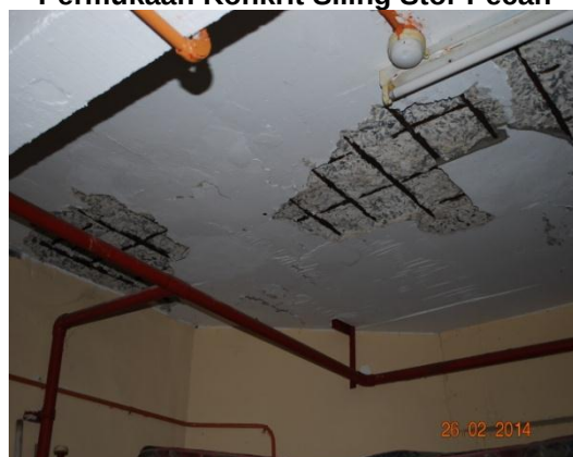
Gambar 1.10 Permukaan Konkrit Siling Stor Pecah
