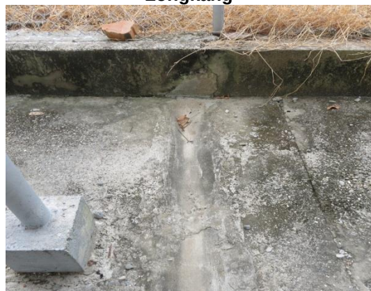
Gambar 4.6 Saluran Air Tidak Disambung Ke Longkang
