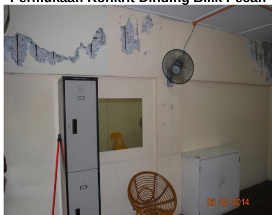
Gambar 1.9 Permukaan Konkrit Dinding Bilik Pecah
