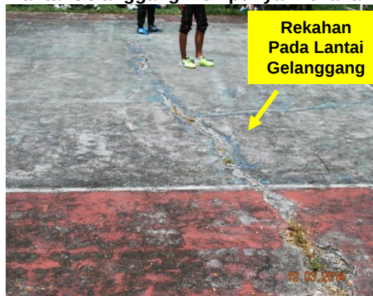
Gambar 1.2 Lantai Gelanggang Mempunyai Rekahan
