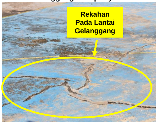
Gambar 1.1 Lantai Gelanggang Mempunyai Rekahan
