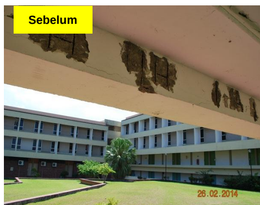
Gambar 1.7 Permukaan Konkrit Bangunan Pecah
