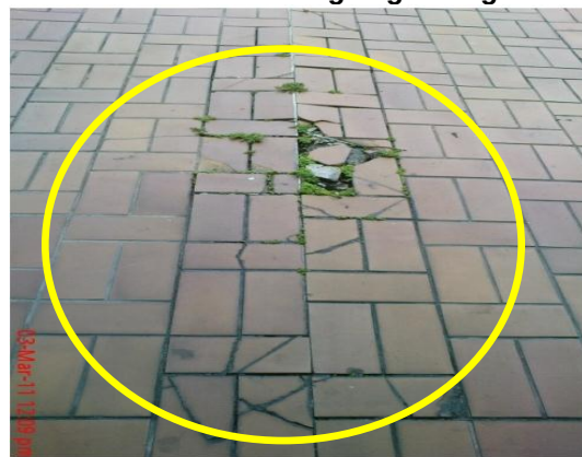
Gambar 6.6 Lantai Rosak Di Ruang Legar Tingkat 3
