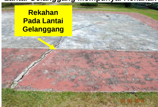
Gambar 1.3 Lantai Gelanggang Mempunyai Rekahan
