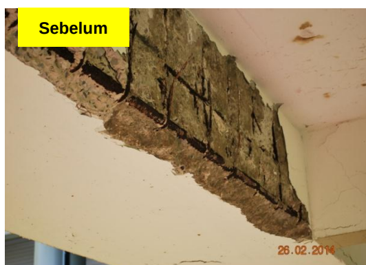
Gambar 1.5 Permukaan Konkrit Bangunan Pecah
