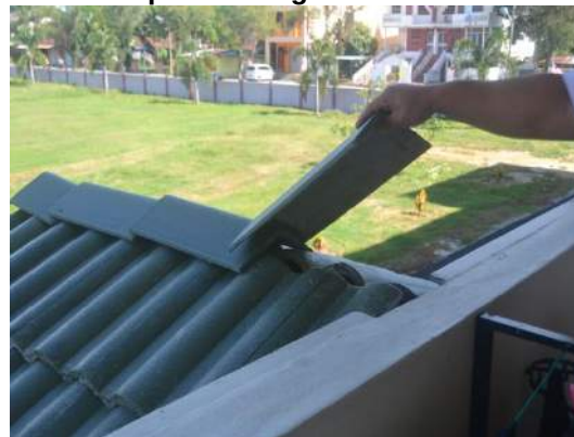
Gambar 1.14 Penutup Bumbung Tidak Dilekatkan
