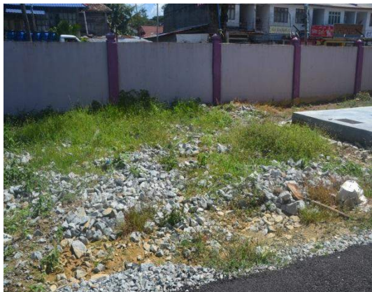
Gambar 1.15 Sisa Binaan Tidak Dibersihkan
