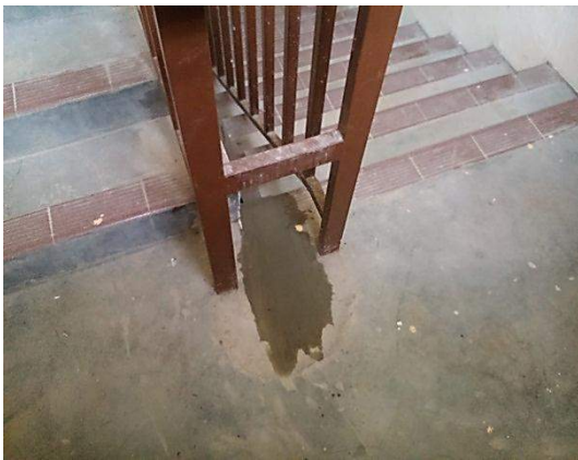
Gambar 1.20 Lubang Di Landing Bay Tangga Ditutup
