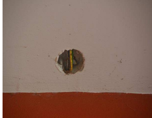
Gambar 1.39 Junction Box Tidak Ditutup
