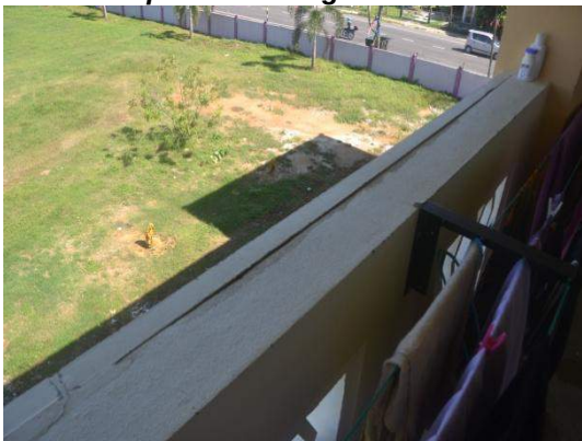
Gambar 1.13 Parapet Wall Yang Telah Retak
