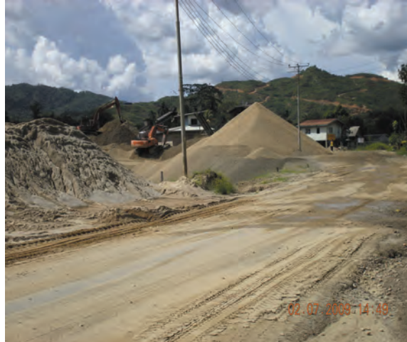
Foto 2.11 Keadaan Jalan Raya Dilitupi Pasir Dan Tidak Berpagar
