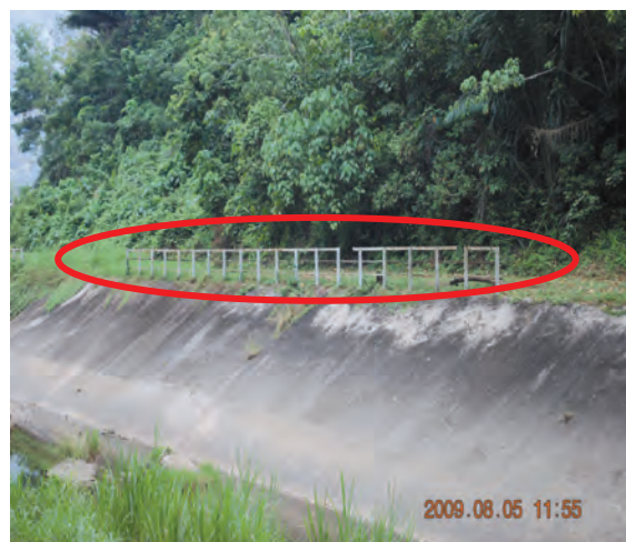
Foto 4.11 Safety Handrail Yang Rosak Dan Hilang Belum Disenggara Dan Diganti
