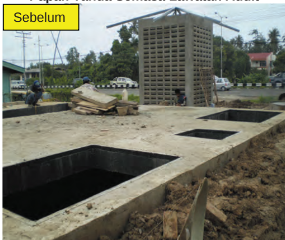
Foto 7.1 Pump Station 1 Tidak Dilengkapi Pagar Dan Papan Tanda Semasa Lawatan Audit
