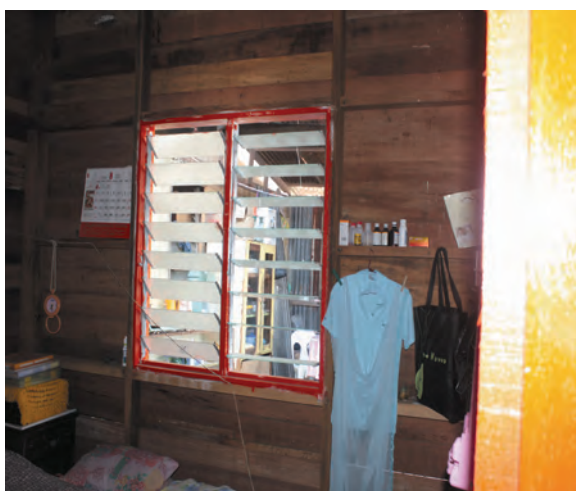
Foto 3.11 Dinding Bilik Tidak Dicat
