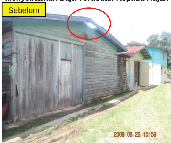
Foto 5.32 Keadaan Atap Stor Yang Rosak Menyebabkan Baja Terdedah Kepada Hujan
