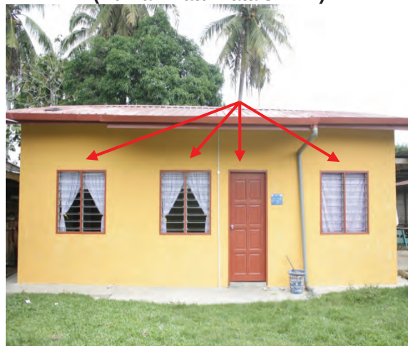
Foto 3.7 Lubang Angin Daripada Batu Bata Di Bahagian Atas Pintu Dan Tingkap Tidak Dipasang (Rumah Batu Bata 3 Bilik)
