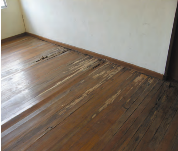
Foto 8.32 Lantai Bilik Mesyuarat Di Dewan Tertutup Yang Telah Reput Dan Rosak
