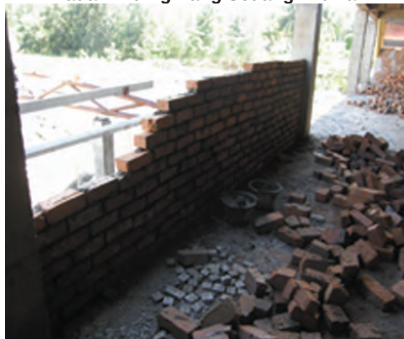
Foto 8.39 Tetulang Exmet Tidak Dipasang Pada Dinding Yang Sedang Dibina
