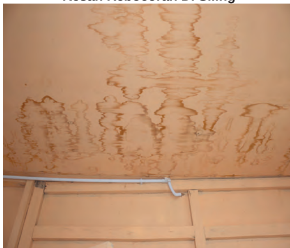
Foto 3.14 Kesan Kebocoran Di Siling
