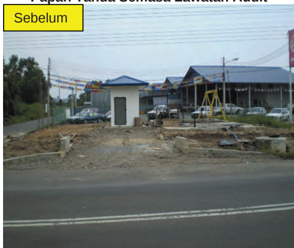
Foto 7.3 Pump Station 2 Tidak Dilengkapi Pagar Dan Papan Tanda Semasa Lawatan Audit
