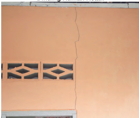
Foto 3.13 Dinding Rumah Retak
