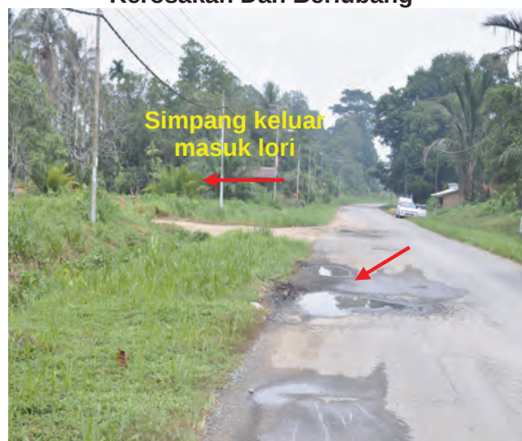
Foto 2.15 Jalan Raya Mengalami Kerosakan Dan Berlubang
