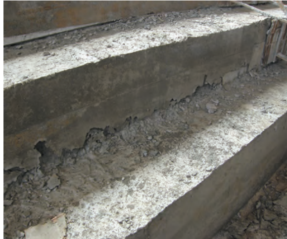
Foto 8.37 Kerja Konkrit Tidak Sempurna Dan Berongga
