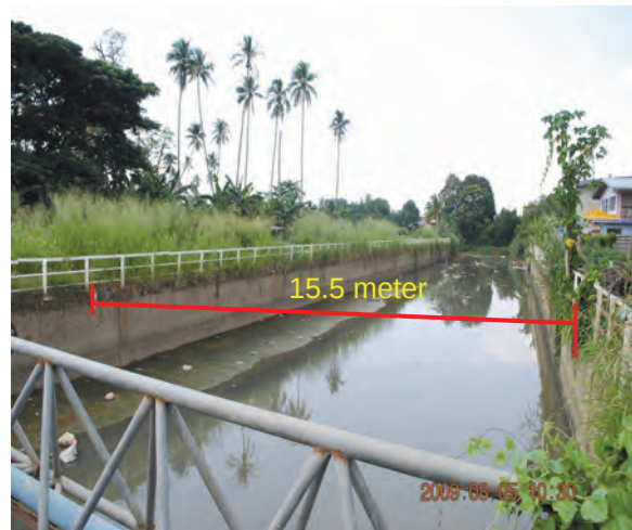
Foto 4.9 Drain 25 Jalan Sin Onn Berukuran Besar Dengan Kelebaran 15.5 Meter
