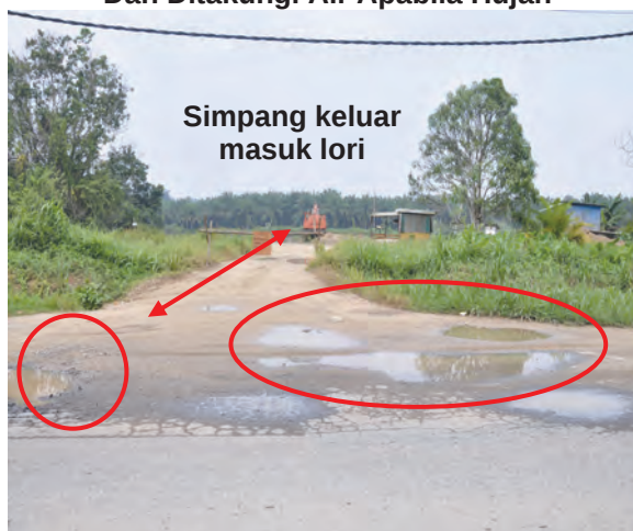
Foto 2.14 Jalan Raya Berlubang Dan Ditakungi Air Apabila Hujan
