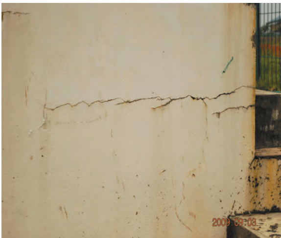
Foto 8.26 Keretakan Di Dinding Astaka
