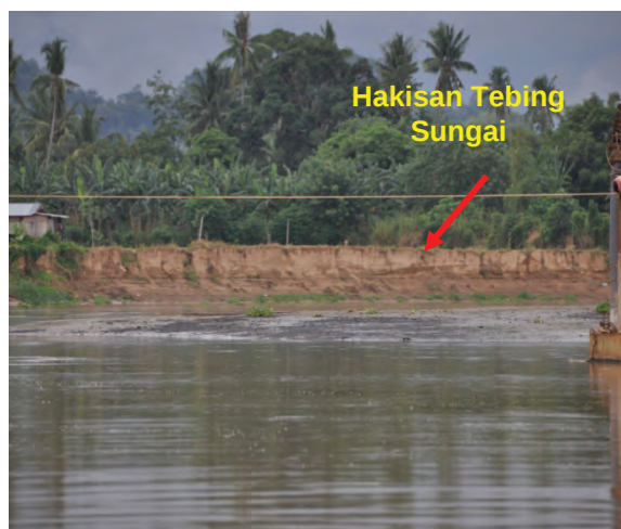
Foto 2.8 Hakisan Tebing Sungai Dalam Kawasan Tiga Pontun Yang Sedang Beroperasi
