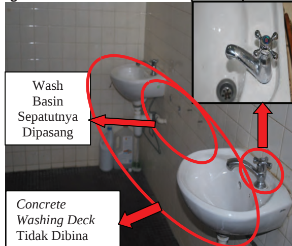
Foto 8.5 Wash Basin Tidak Dipasang, Concrete Washing Deck Tidak Dibina Dan Kepala Paip Tidak Diganti
