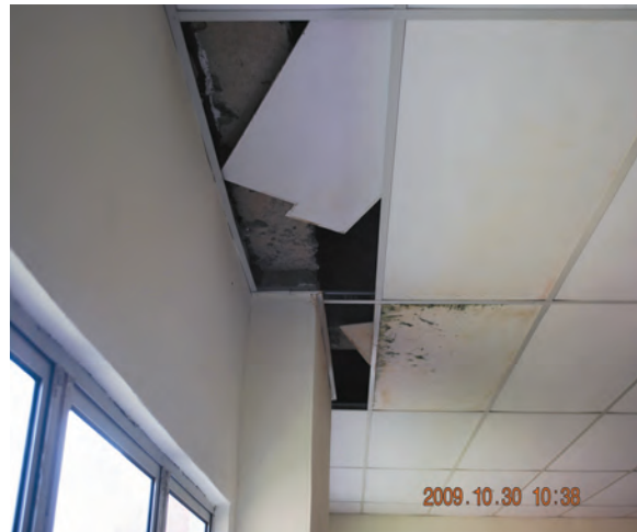
Foto 8.31 Siling Rosak Berpunca Daripada Resapan Air
