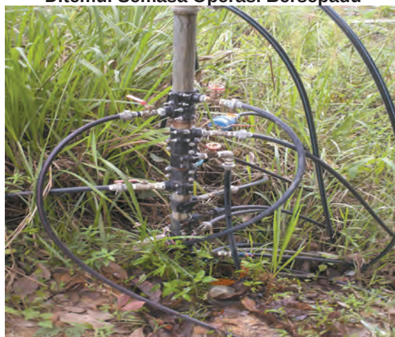
Foto 6.4 Sambungan Paip Haram Yang Ditemui Semasa Operasi Bersepadu
