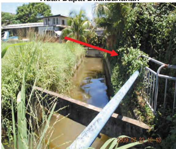
Foto 4.20 Pagar Dibina Hingga Ke Tepi Saliran Menyebabkan Penyenggaraan Tidak Dapat Dilaksanakan
