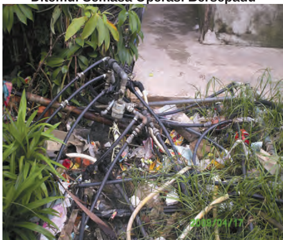
Foto 6.3 Sambungan Paip Haram Yang Ditemui Semasa Operasi Bersepadu
