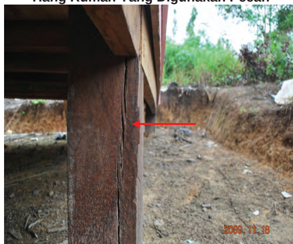
Foto 3.15 Tiang Rumah Yang Digunakan Pecah
