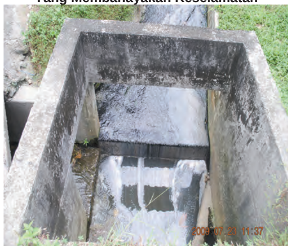
Foto 4.10 Drainage Sump Tidak Ditutup Dengan Mild Steel Cover/Grill Yang Membahayakan Keselamatan
