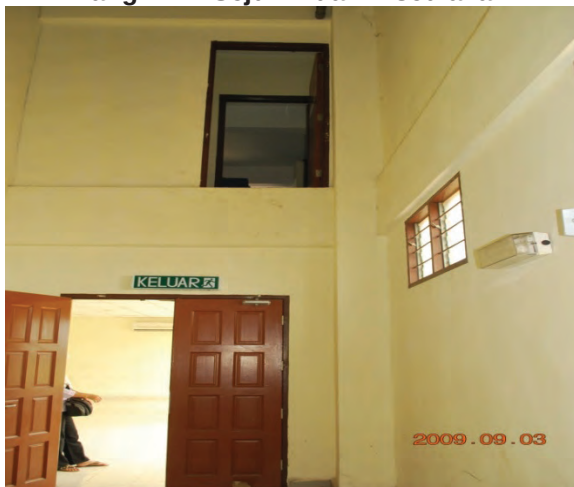
Foto 8.7 Tangga Untuk Ke Bilik Tangki Air Sejuk Tidak Disediakan
