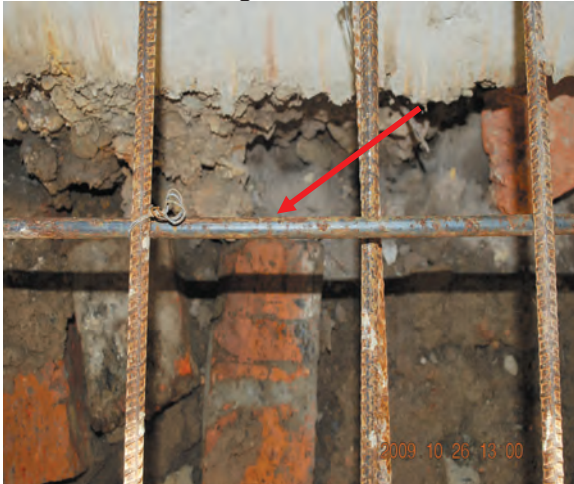
Foto 8.36 Mild Steel Yang Dipasang Sebagai Besi Tetulang Menggantikan Jenis High Tensile Steel
