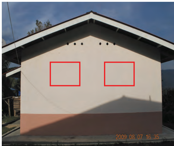
Foto 3.6 Dua Tingkap Di Sisi Kiri Rumah Tidak Dipasang (Rumah Batu Bata 3 Bilik)
