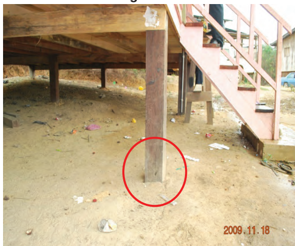
Foto 3.8 Batu Asas Tiang Rumah Tidak Dibina
