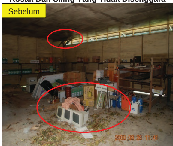
Foto 5.34 Keadaan Stor Yang Tidak Bersih, Menyimpan Monitor Yang Rosak Dan Siling Yang Tidak Disenggara
