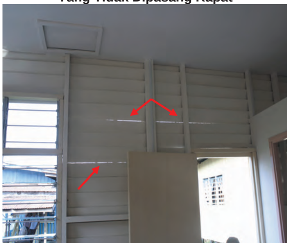
Foto 3.16 Dinding Papan Tindih Kasih Yang Tidak Dipasang Rapat
