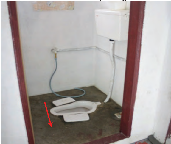
Foto 3.4 Lantai Tandas Tidak Dipasang Seramik
