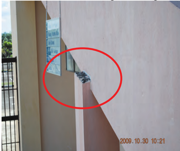
Foto 8.13 Binaan Tiang Konkrit Tidak Sama Rata Dengan Dinding
