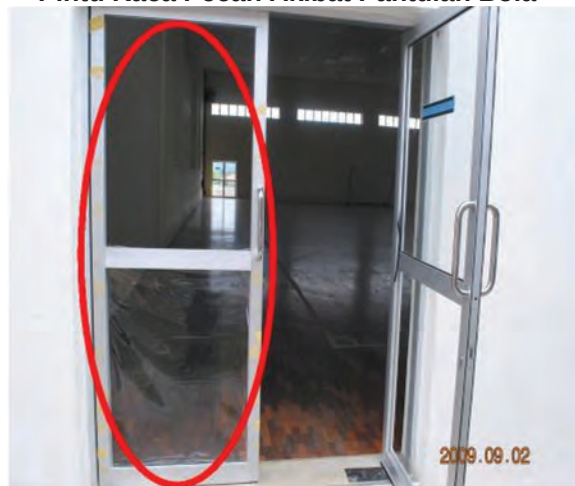
Foto 8.17 Pintu Kaca Pecah Akibat Pantulan Bola
