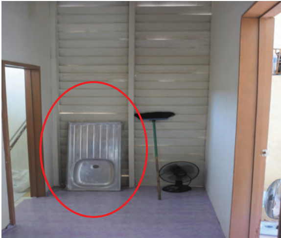
Foto 3.2 Sinki Tidak Dipasang
