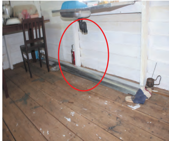
Foto 3.3 Paip Sinki Tidak Dipasang
