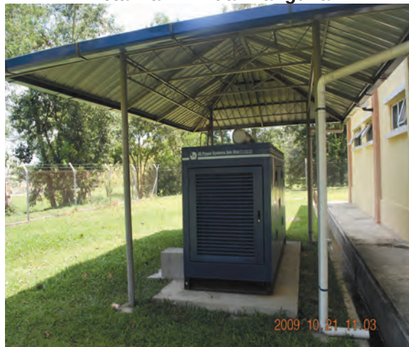
Foto 8.12 Set Generator Diletakkan Di Luar Bangunan
