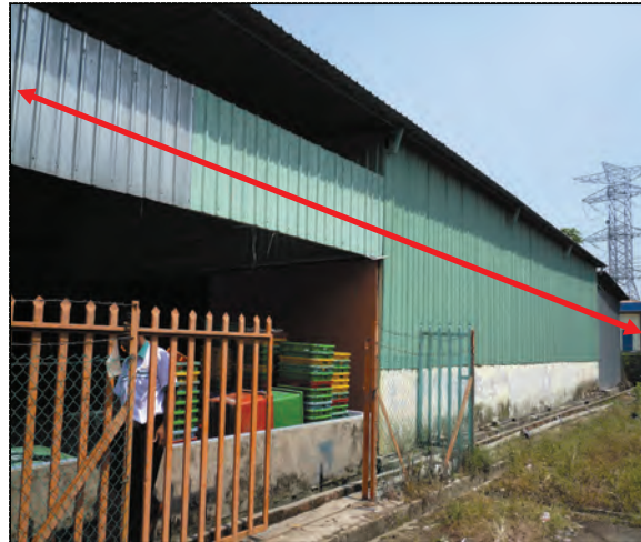
Foto 14.3 Pertambahan Struktur Bangunan Tanpa Kebenaran
