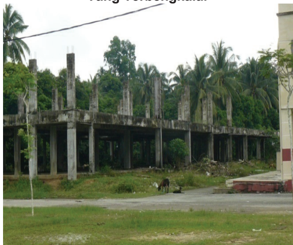
Foto 4.3 Projek Kedai Fasa 1 Lot 1538-1544 Yang Terbengkalai
