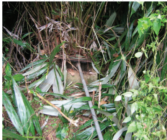
Foto 5.26 Kedudukan End Point Chamber
