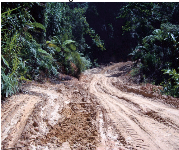
Foto 3.10 Bekas Jalan Sekunder Yang Digunakan Sebagai Jalan Utama
