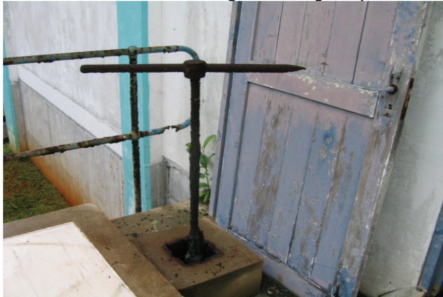
Foto 5.18 Alat Pembuka Valve Tangki Air Imbangan Reput
