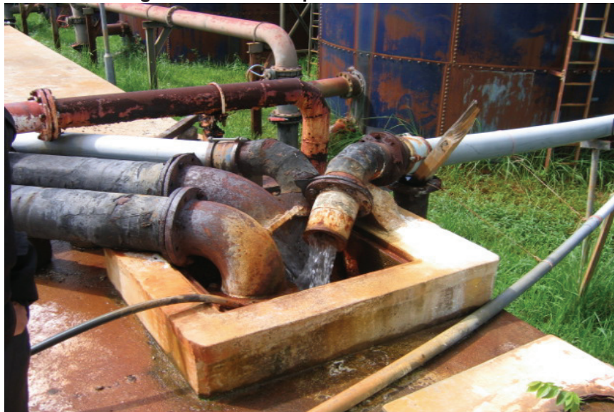
Foto 5.2 Air Mentah Dipam Terus Kepada Tangki Air Bersih Tanpa Proses Rawatan
