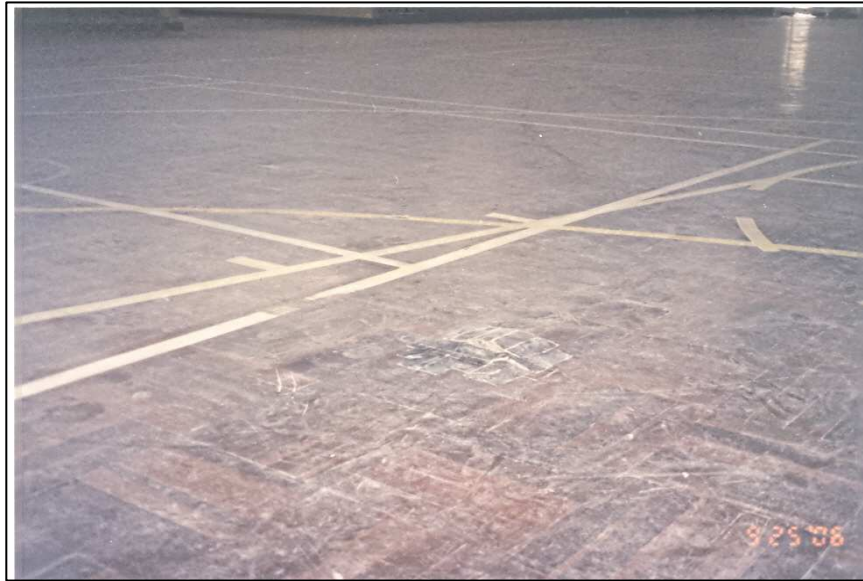
Foto 44 Kerosakan Lantai Gelanggang Badminton Dan Bola Keranjang
