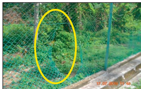
Seberang Perai Utara, Pulau Pinang Struktur Menara Kampung Tok Bedu - Kerosakan Dawai Pagar (17.07.2019) (Sumber: Jabatan Audit Negara)
