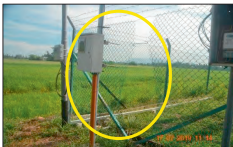
Seberang Perai Utara, Pulau Pinang Struktur Menara Permatang Bendahari - Kerosakan Dawai Pagar (17.07.2019) (Sumber: Jabatan Audit Negara)
