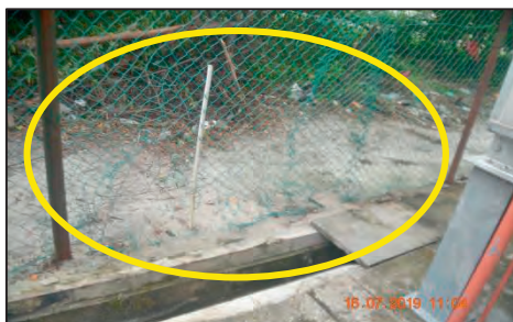
Daerah Barat Daya, Pulau Pinang Struktur Menara Bayan Bay - Kerosakan Dawai Pagar (16.07.2019) (Sumber: Jabatan Audit Negara)
