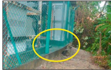
Daerah Barat Daya, Pulau Pinang Struktur Menara Kampung Seronok - Hakisan Tanah di Tepi Pagar Struktur Menara (16.07.2019) (Sumber: Jabatan Audit Negara)
