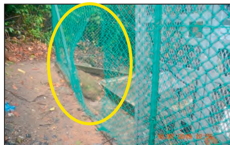
Daerah Barat Daya, Pulau Pinang Struktur Menara Kampung Seronok - Kerosakan Dawai Pagar (16.07.2019) (Sumber: Jabatan Audit Negara)
