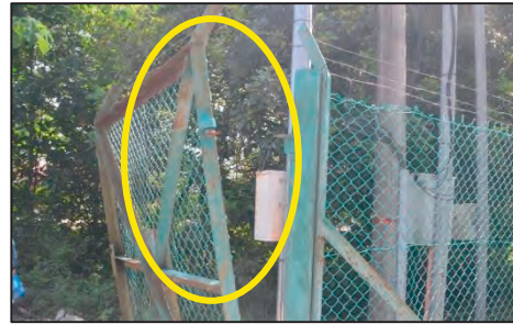
Seberang Perai Tengah, Pulau Pinang Struktur Menara Taman Ara Indah - Kerosakan Pintu Pagar (17.07.2019) (Sumber: Jabatan Audit Negara)
