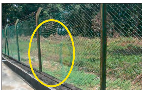
Seberang Perai Tengah, Pulau Pinang Struktur Menara Bukit Teh - Kerosakan Dawai Pagar (17.07.2019) (Sumber: Jabatan Audit Negara)
