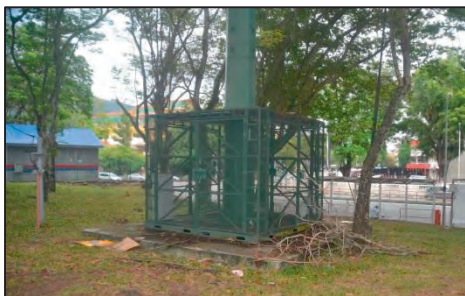
George Town, Pulau Pinang Struktur Menara Jalan Masjid Negeri - Struktur Menara Sementara Tidak Beroperasi (16.07.2019) (Sumber: Jabatan Audit Negara)
