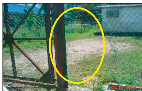
Seberang Perai Tengah, Pulau Pinang Struktur Menara Cerok To'Kun - Kerosakan Dawai Pagar (17.07.2019) (Sumber: Jabatan Audit Negara)
