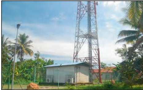
Tasek Gelugor, Pulau Pinang Struktur Menara Kampung Tok Bedu -Struktur Menara Dibina Tanpa Kelulusan PBT (17.07.2019) (Sumber: Jabatan Audit Negara)
