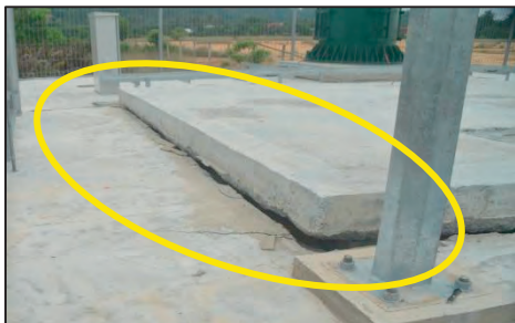
Batu Kawan, Pulau Pinang Struktur Menara Cresentia Park - Mendapan Tanah Menyebabkan Keretakan Simen di Sekeliling Struktur Menara (19.06.2019) (Sumber: Jabatan Audit Negara)
