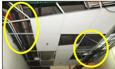
KOMTAR Fasa 1 - Keadaan Siling di Tingkat 61 yang Rosak (04.07.2018)
