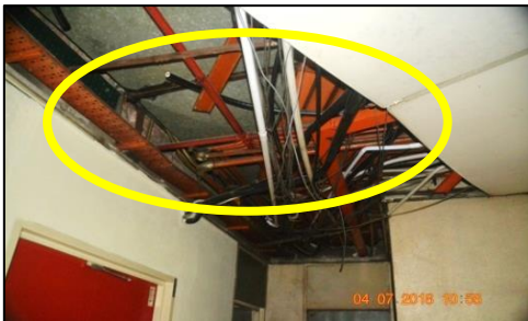
KOMTAR Fasa 1 - Keadaan Siling di Tingkat 3 yang Rosak (04.07.2018)
