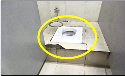
KOMTAR Fasa 1 - Keadaan Tandas yang Kurang Bersih dan Rosak (04.07.2018)
