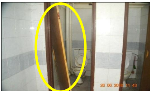
Kompleks Penjaja Bukit Tengah - Pintu Tandas yang Rosak (26.06.2018)
