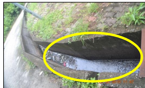
Kompleks Penjaja Bukit Tengah - Keadaan Longkang yang Kotor (26.06.2018)
