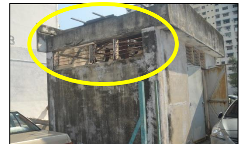
Perumahan Pelangi Macallum - Kerosakan Struktur Bilik Pam Bomba (05.07.2018)
