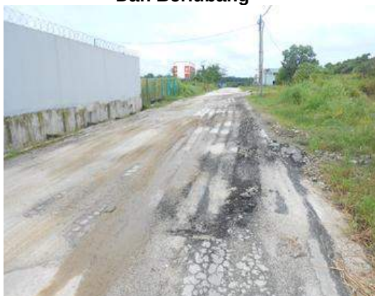
Gambar 4.7 Jalan Yang Dinaiktaraf Rosak Dan Berlubang
