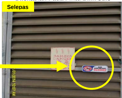
Gambar 1.10 Notis DILARANG MEROKOK Dilekatkan Pada Pintu Bilik Suis
