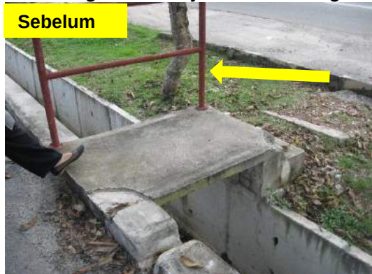
Gambar 4.3 Railing Laluan Pejalan Kaki Hilang
