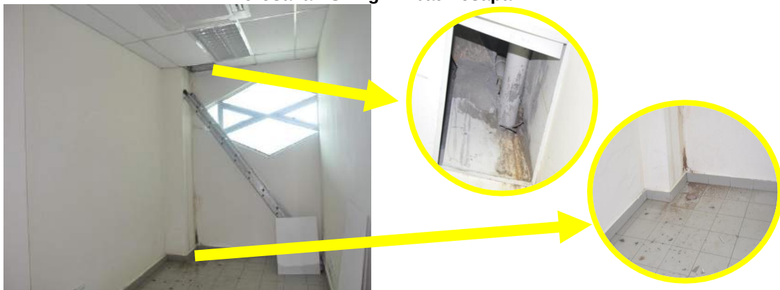
Gambar 1.14 Kerosakan Siling Akibat Resapan Air
