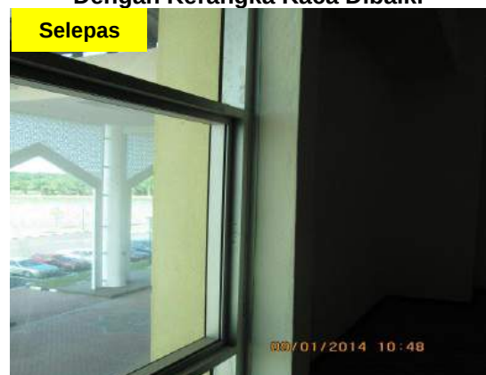
Gambar 1.2 Renggangannya Antara Dinding Struktur Utama Dengan Kerangka Kaca Dibaiki
