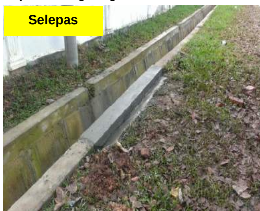
Gambar 4.2 Lepaan Longkang Pecah Telah Dibaiki
