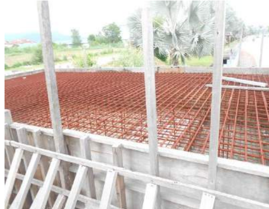
Gambar 4.18 Kerja Pembinaan Terbengkalai
