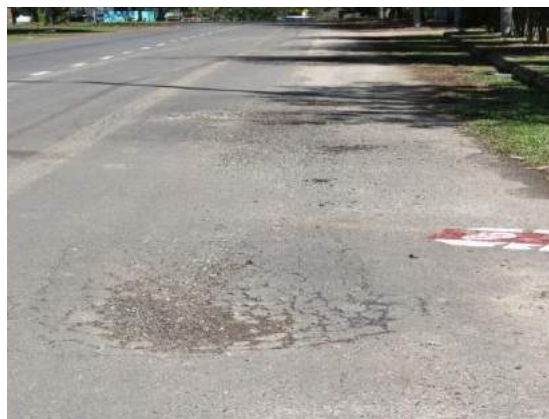
Gambar 4.8 Kerosakan Di Permukaan Jalan
