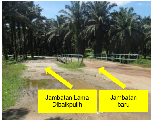
Gambar 4.12 Keadaan Jambatan di Tapak Pelupusan Sampah
