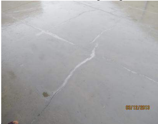
Gambar 1.11 Keretakan Pada Lepaan Simen Di Permukaan Bumbung Bangunan
