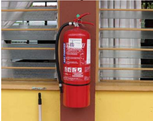
Gambar 2.11 Alat Pemadam Api Yang Diselenggara Dengan Baik Dan Di Gantung Di Dinding Kelas
