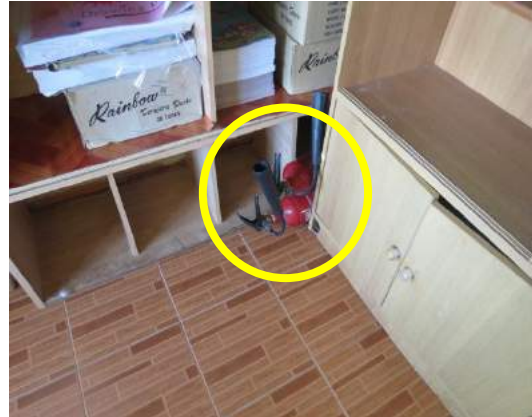
Gambar 2.12 Alat Pemadam Api Yang Tidak Diselenggara Dengan Teratur Dan Diletak Di Atas Lantai
