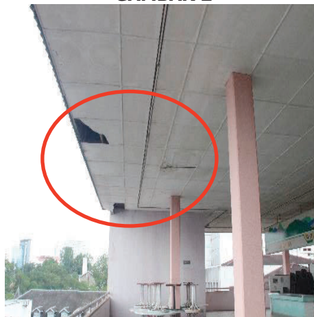
Bangunan Saujana (Lot Gerai) - Struktur Siling Rosak (13.06.2024) (Sumber: Jabatan Audit Negara)
