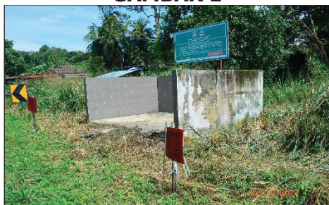
PPSD Kg. Kolam, Tanjung Rambutan - Tapak Telah Dikosongkan dan Diletakkan Papan Tanda Larangan Membuang Sampah (5.12.2023) Sumber: Jabatan Audit Negara
