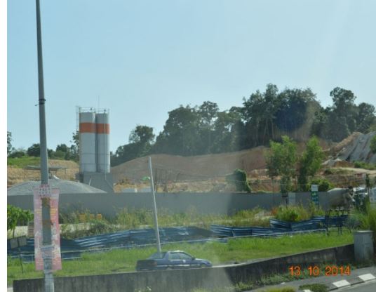
Gambar 2.2 Kuari Beroperasi Tanpa Permit
