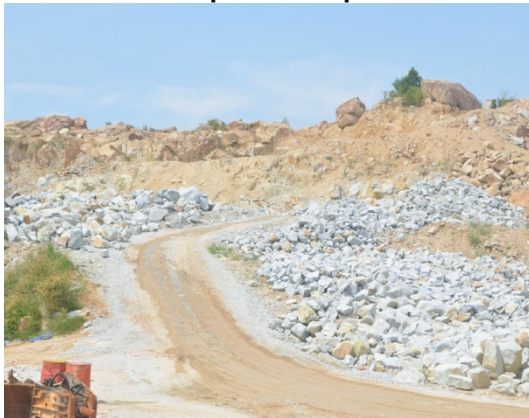
Gambar 2.3 Kuari Beroperasi Tanpa Permit
