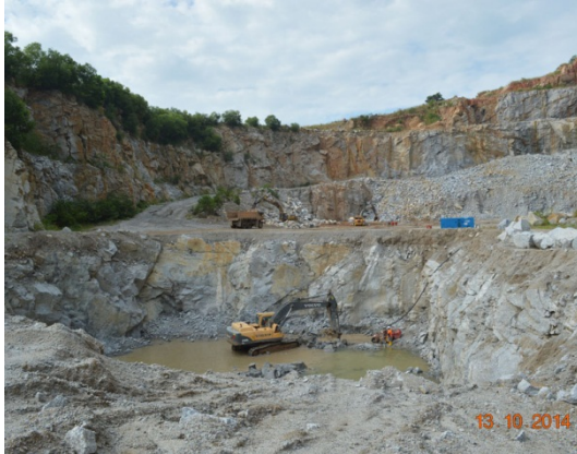
Gambar 2.1 Kuari Beroperasi Tanpa Permit
