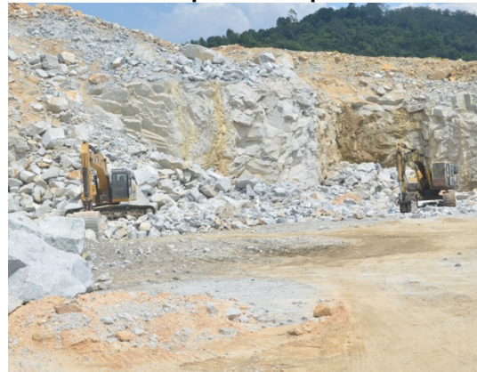
Gambar 2.4 Kuari Beroperasi Tanpa Permit
