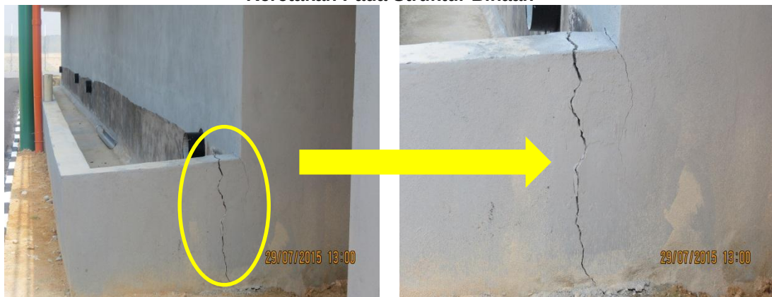
Gambar 4.10 Keretakan Pada Struktur Binaan
