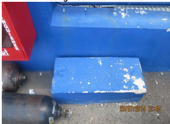
Gambar 4.5 Kerosakan Bangunan Akibat Kerja-Kerja Memasang Mesin Dan Peralatan
