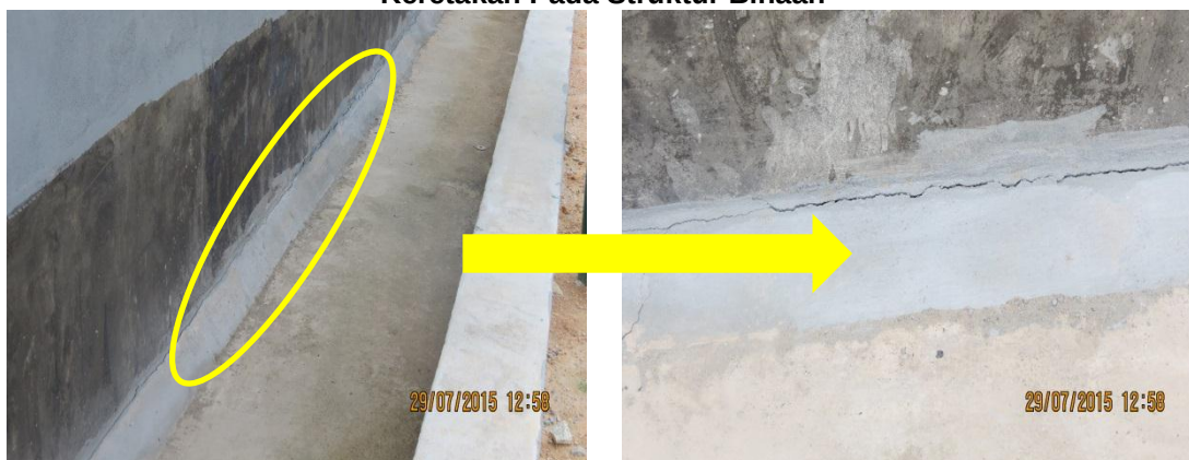
Gambar 4.12 Keretakan Pada Struktur Binaan
