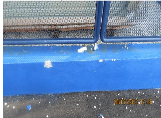
Gambar 4.8 Kerosakan Bangunan Akibat Kerja-Kerja Memasang Mesin Dan Peralatan
