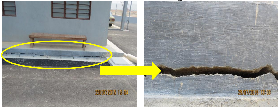
Gambar 4.9 Keretakan Pada Struktur Bangunan
