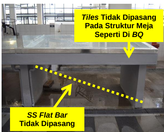
Gambar 3.14 SS Flat Bar Dan Tiles Tidak Dipasang Pada Meja Makanan Laut
