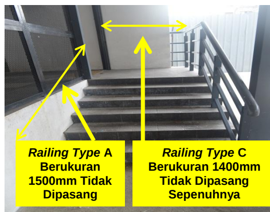
Gambar 3.16 Railing Type A Dan C Di Tangga Entrance 3 Tidak Dipasang
