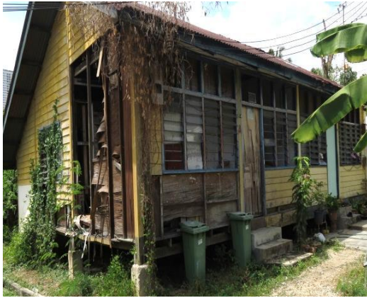
Gambar 1.18 Rumah Panjang Terbiar, Rosak Dan Masih Belum Dirobohkan
