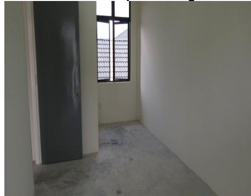
Gambar 1.25 Blok Asrama Siap Tidak Digunakan
