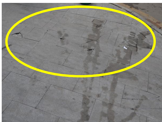
Gambar 3.23 Interlocking Block Telah Pecah Akibat Laluan Kenderaan
