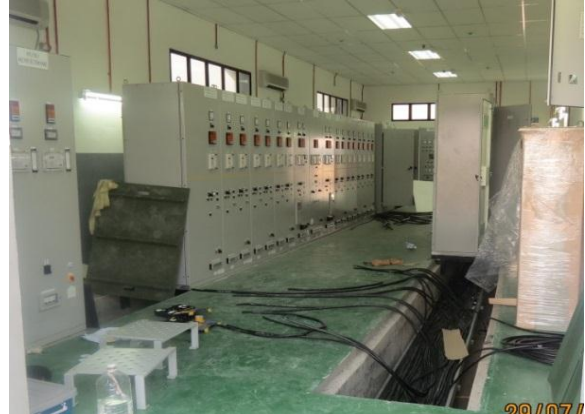
Gambar 4.2 Mesin-Mesin Dan Peralatan Telah Dipasang
