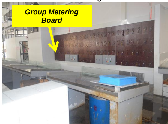
Gambar 3.30 Lokasi Group Metering Board Di Pasar Basah Yang Merbahaya Kerana Tiada Perlindungan
