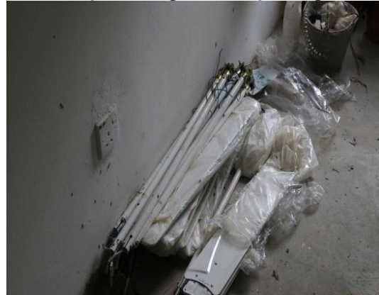
Gambar 1.29 Kipas Siling Tidak Dipasang
