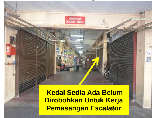
Gambar 3.10 Kerja Pemasangan Escalator Di Tingkat 1 Belum Disiapkan
