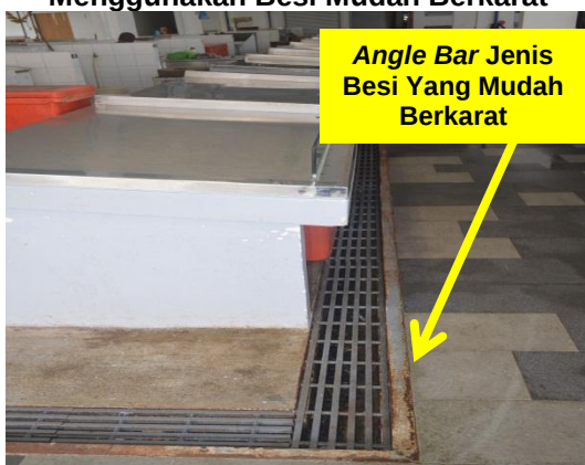
Gambar 3.15 Angle Bar Yang Dipasang Tidak Menggunakan Jenis FRP Tetapi Menggunakan Besi Mudah Berkarat
