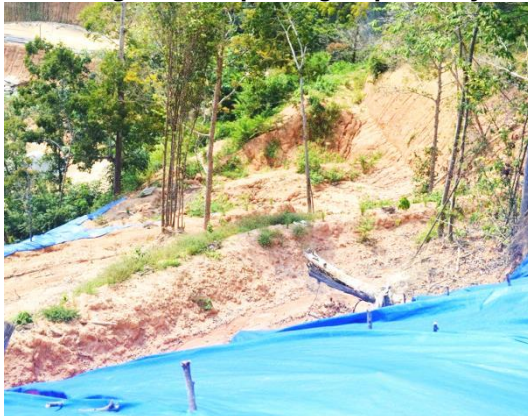
Gambar 2.31 Netting Tidak Dipasang Sepenuhnya
