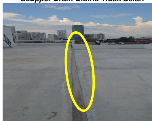
Gambar 3.26 Scupper Drain Dibina Tidak Selari
