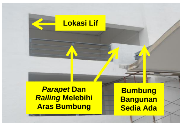
Gambar 3.32 Pemasangan Parapet Dan Railing Tidak Melindungi Lif Daripada Tempias Hujan
