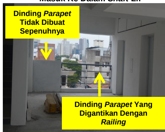
Gambar 3.18 Dinding Parapet Tidak Dibuat Sepenuhnya Mengakibatkan Tempias Air Hujan Dan Masuk Ke Dalam Shaft Lif
