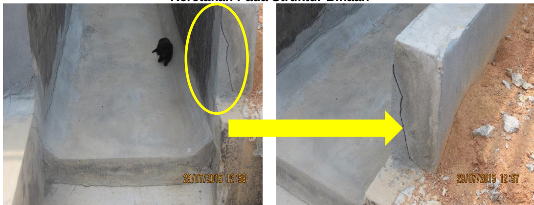
Gambar 4.11 Keretakan Pada Struktur Binaan
