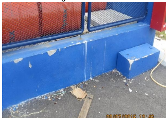
Gambar 4.6 Kerosakan Bangunan Akibat Kerja-Kerja Memasang Mesin Dan Peralatan
