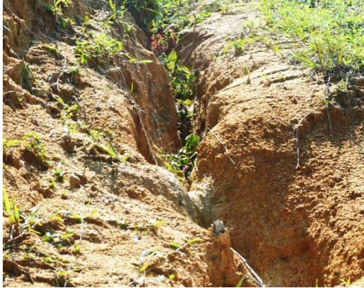
Gambar 2.27 Gully Belum Dibaikpulihan
