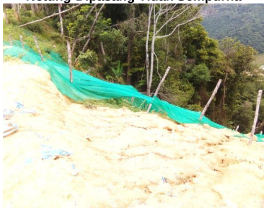
Gambar 2.25 Netting Dipasang Tidak Sempurna
