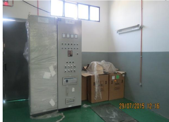
Gambar 4.4 Mesin-Mesin Dan Peralatan Telah Dipasang
