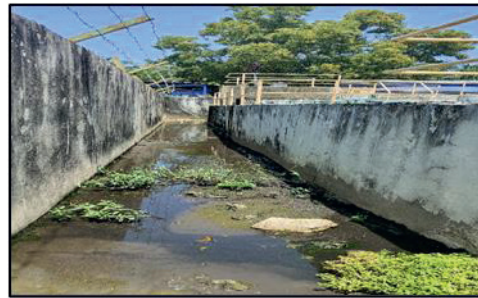
Syarikat 904152-D, Kelantan [Persendirian] - Kebocoran di Kawasan Chloronation Chamber dan Menyebabkan Limpahan Efluen di Tepi Kolam Rawatan (10.10.2023) (Sumber: Jabatan Audit Negara)
