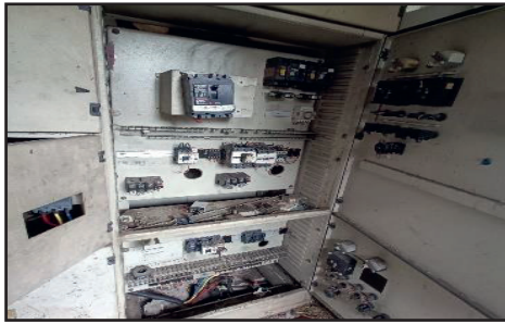
Taman Kingfisher Fasa II, Kota Kinabalu, Sabah - Komponen Panel Elektrik Pam dan Blower Tidak Berfungsi (17.02.2023) (Sumber: Jabatan Audit Negara)
