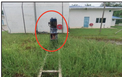
LRA Jaya Bakti, Beluran - Mixer Pada Sludge Pool/Rosak (23.05.2023) (Sumber: Jabatan Audit Negara)
