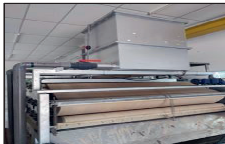
LRA Jaya Bakti, Beluran - Sistem Pemproses Enap Cemar Loji Rawatan Tidak Digunakan (23.05.2023) (Sumber: Jabatan Audit Negara)
