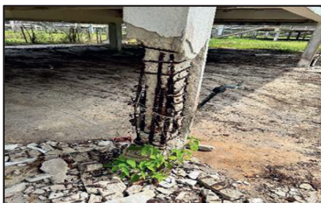
APU Zon A – A1, Projek Agropolitan Besut Setiu - Keretakan dan Pecah pada Tiang Konkrit (24.05.2023) (Sumber: Jabatan Audit Negara)
