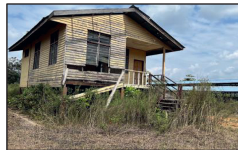
Rumah Pekerja - Rumah Pekerja yang Tidak Digunakan (07.03.2023) (Sumber: Jabatan Audit Negara)
