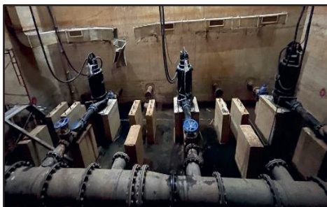
Stesen Pam KLR 146 - Tiga Unit Raw Sewage Pump yang Baru dengan Reka Bentuk Semula (21.03.2023) (Sumber: Jabatan Audit Negara)
