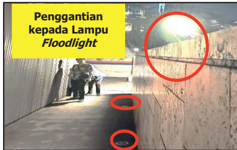
Interpretive Terrace, Masjid Jamek - Lampu L10-1 Tidak Menyala dan Digantikan Dengan Lampu Floodlight yang Tidak Mengikut Spesifikasi Asal (24.02.2023) (Sumber: Jabatan Audit Negara)
