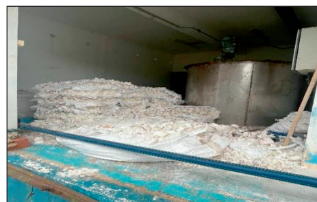
LRA Jengka 3-7 - Bahan Kimia yang Tidak Digunakan dan Rosak (28.02.2023) (Sumber: Jabatan Audit Negara)
