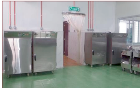
Pusat Inkubator Wilayah Utara - 4 Electric Oven Dryer Bernilai RM25,600 Belum Dipasang dan Belum Menjalani T&C (19.09.2022) (Sumber: Jabatan Audit Negara)
