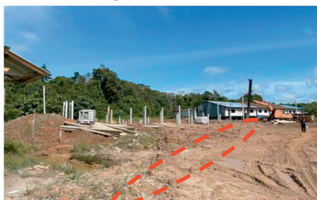
WUP8 - Tapak Projek Tidak Dilengkapi Dengan Hoarding (11.01.2023) (Sumber: Jabatan Audit Negara)
