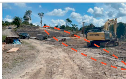
WUP10 - Tapak Projek Tidak Dilengkapi Dengan Hoarding (11.01.2023) (Sumber: Jabatan Audit Negara)
