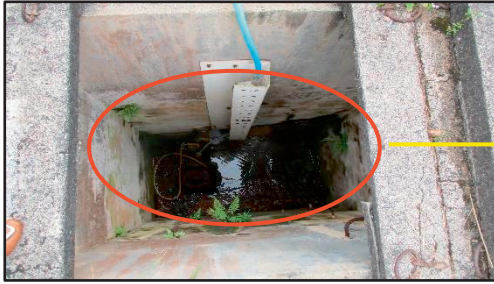
Kolam Imbangan Palong 1, Daerah Tampin - Aliran Air Deras Pada Paip Limpahan (18.01.2023) (Sumber: Jabatan Audit Negara)
