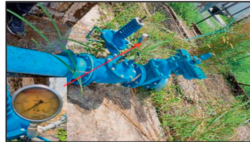
Rumah Pam Ulu Yoh, Daerah Tampin - Pressure Meter Gauge Pada Altitude Valve Telah Rosak dan Tidak Berfungsi (08.02.2023) (Sumber: Jabatan Audit Negara)
