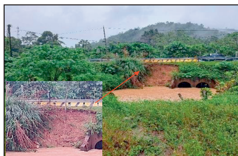
Kampung Bukit Perah, Jempol - Cerun Bersebelahan Pembetung Lintasan Jalan Milik JKR Daerah Jempol Mengalami Hakisan (01.03.2023) (Sumber: Jabatan Audit Negara)
