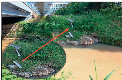
Jambatan JKR Daerah di Pekan Kota, Rembau - Keruntuhan Struktur Gabion Milik JKR yang Telah Menutupi Saluran Keluar Roadside Drain yang Memasuki Sungai Kendong (06.03.2023) (Sumber: Jabatan Audit Negara)
