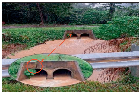
Kampung Bukit Perah, Jempol - Wing Wall/Pembetung Milik JKR Daerah Jempol Mengalami Kegagalan dan Hampir Runtuh (01.03.2023) (Sumber: Jabatan Audit Negara)
