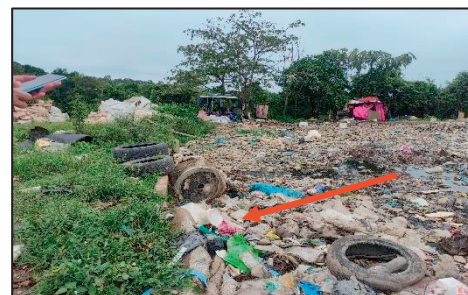
TPSP Sungai Ikan - Struktur Longkang Runtuh Menyebabkan Laluan Air Larian Tersekat (12.09.2022) (Sumber: Jabatan Audit Negara)
