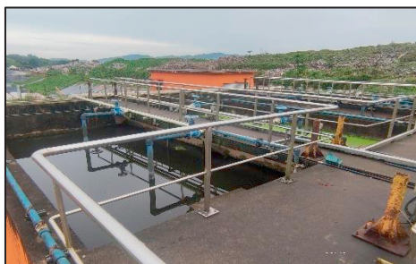
TPSP Sungai Ikan - Sistem LTP Tidak Berfungsi (12.09.2022) (Sumber: Jabatan Audit Negara)
