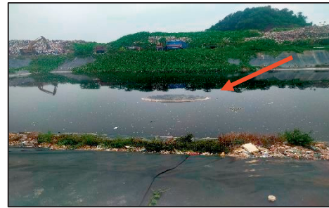
TPSP Sungai Ikan - Kolam Takungan Terbiar dan Lapisan Liner Didapati Rosak (12.09.2022) (Sumber: Jabatan Audit Negara)
