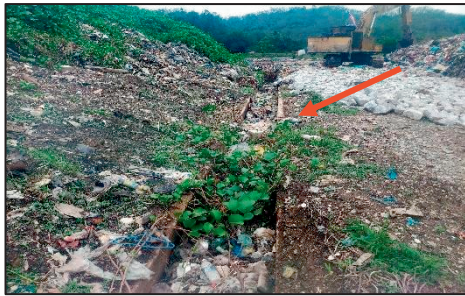
TPSP Sungai Ikan - Longkang Sel Tersumbat dengan Sisa Pepejal (12.09.2022) (Sumber: Jabatan Audit Negara)
