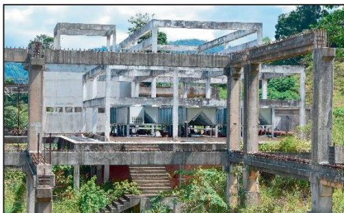
Pulau Bayas, Tasik Kenyir - Keadaan Chiller Terbiar dan Rosak (22.05.2023) (Sumber: Jabatan Audit Negara)
