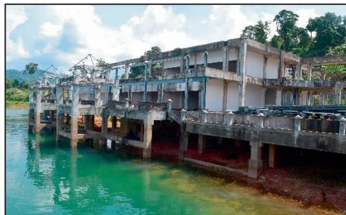
Pulau Bayas, Tasik Kenyir - Bangunan Kenyir Trade Center Terbengkalai (22.05.2023) (Sumber: Jabatan Audit Negara)
