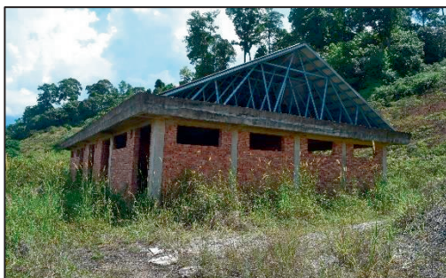
Pulau Bayas, Tasik Kenyir - Bangunan TNB Substation Tidak Siap dan Terbengkalai (22.05.2023) (Sumber: Jabatan Audit Negara)
