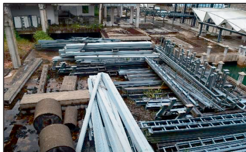
Pulau Bayas, Tasik Kenyir - Material on Site (Kerangka Bumbung) Terbiar (22.05.2023) (Sumber: Jabatan Audit Negara)
