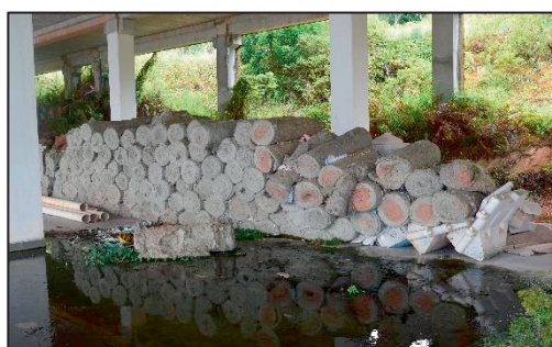
Pulau Bayas, Tasik Kenyir - Material on Site ( Rockwool Insulation ) Terbiar (22.05.2023) (Sumber: Jabatan Audit Negara)
