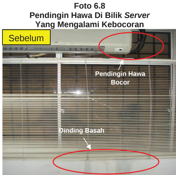
Sumber: Jabatan Audit Negara Lokasi: Bilik Server PTKM Tarikh: 19 Mei 2010
