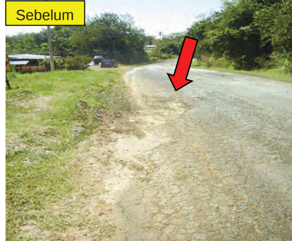
Foto 3.2 Jalan Yang Perlu Pembaikan Segera
