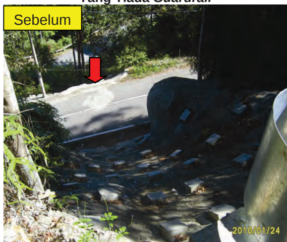
Foto 3.31 Jalan Bercerun Tinggi Yang Tiada Guardrail
