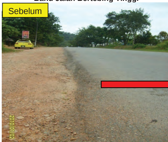
Foto 3.13 Bahu Jalan Bertebing Tinggi
