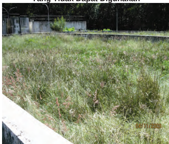
Foto 9.2 Kolam Rawatan Air Yang Tidak Dapat Digunakan
