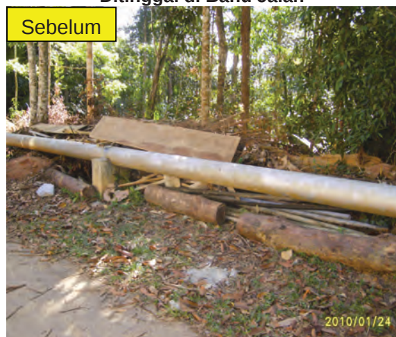
Foto 3.30 Bahan/Sisa Kerja Penyenggaraan Jalan Ditinggal di Bahu Jalan
