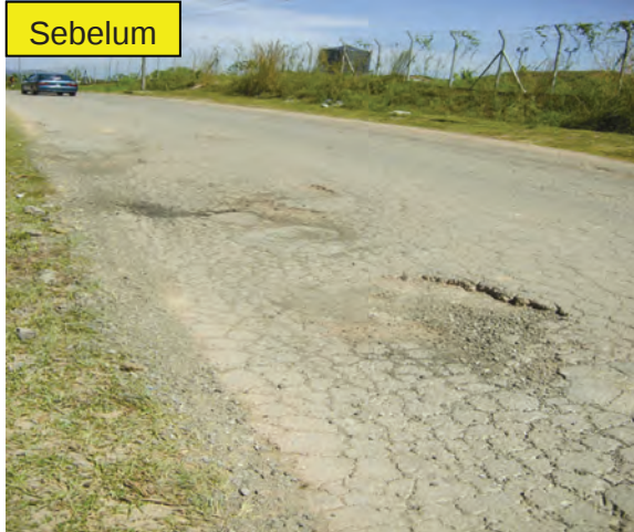
Foto 3.1 Jalan Yang Perlu Pembaikan Segera
