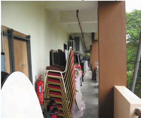
Foto 11.5 Aset Diletakkan Di Koridor Bangunan Kerana Ketiadaan Stor Yang Mencukupi
