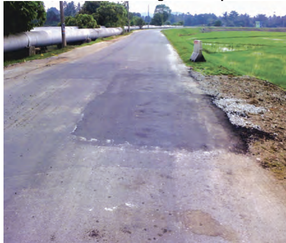
Foto 7.21 Kerosakan Jalan Yang Telah Diperbaiki
