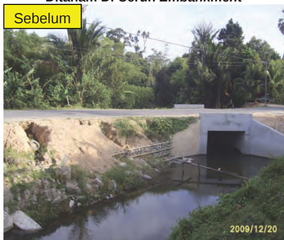
Foto 3.23 Tebing Runtuh, Mendap Dan Rumput Tidak Ditanam Di Cerun Embankment
