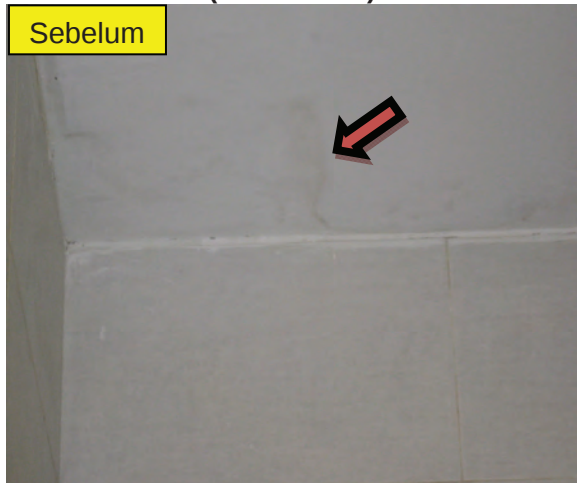
Foto 8.4 Siling Bocor Di Bilik Eksekutif (Chalet Baru)
