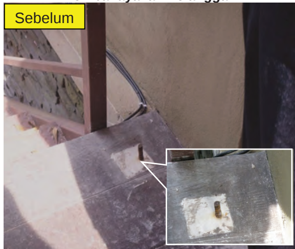
Foto 8.10 Sisa Besi Dibiarkan Terpacak Di Tangga Bilik Eksekutif Yang Boleh Membahayakan Pelanggan
