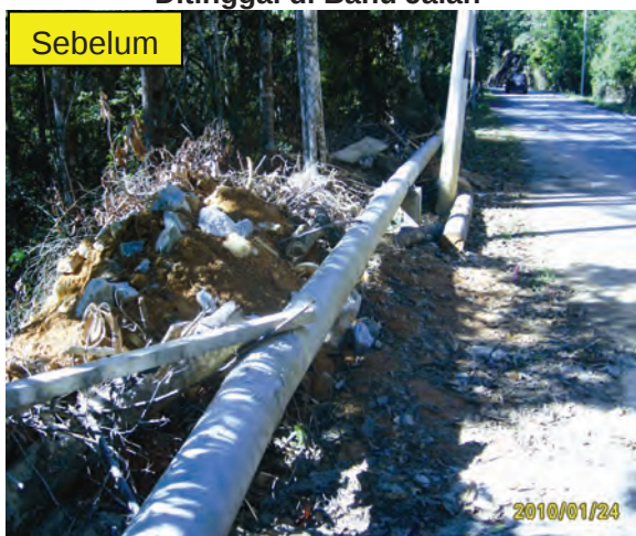
Foto 3.29 Bahan/Sisa Kerja Penyenggaraan Jalan Ditinggal di Bahu Jalan
