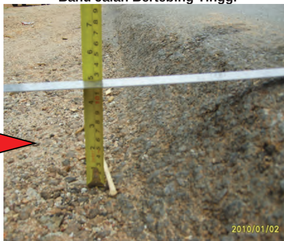
Foto 3.14 Bahu Jalan Bertebing Tinggi
