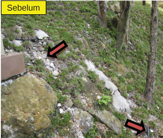
Foto 8.12 Penanaman Rumput Yang Tidak Sempurna Dan Paip Air Yang Terdedah
