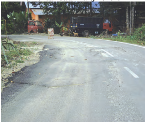
Foto 7.14 Permukaan Jalan Yang Berlekuk
