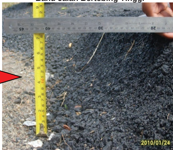
Foto 3.16 Bahu Jalan Bertebing Tinggi
