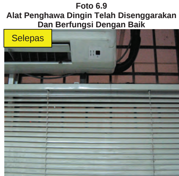
Sumber: PTKM Lokasi: Bilik Server PTKM Tarikh: 7 Julai 2010
