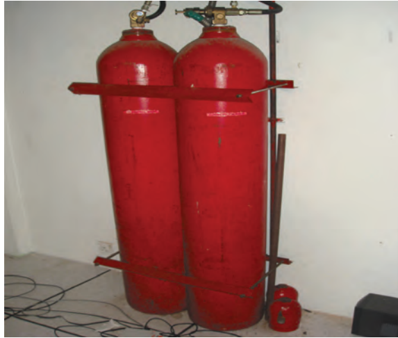
Foto 6.5 Alat Pemadam Api Di Bilik Server
