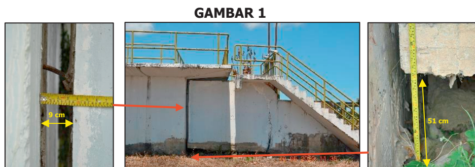
Staircase 20,000 PE - Keretakan Struktur Kolam Disebabkan oleh Mendapan Tanah (12.05.2023) (Sumber: Jabatan Audit Negara)
