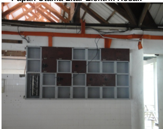
Gambar 5.26 Papan Utama Litar Elektrik Rosak
