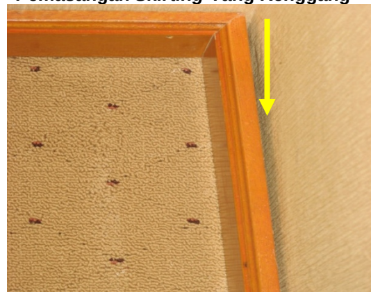
Gambar 2.5 Pemasangan Skirting Yang Renggang
