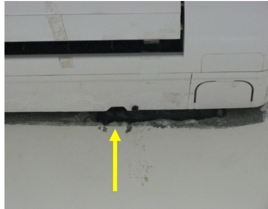
Gambar 2.9 Pemasangan Penyaman Udara Tidak Kemas Di Bilik Kebal
