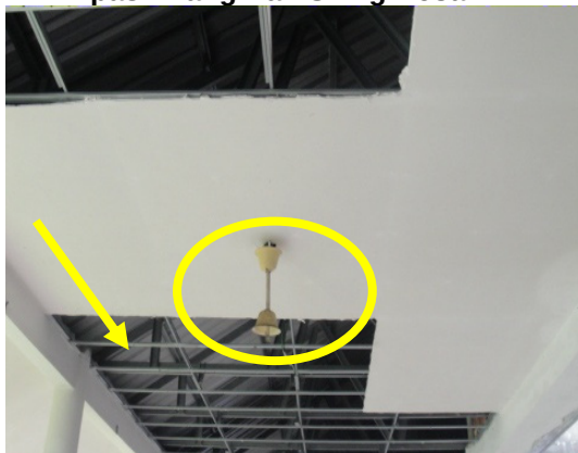
Gambar 5.24 Kipas Hilang Dan Siling Rosak
