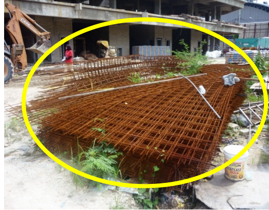
Gambar 13.13 Besi Yang Diletakkan Di tempat Terbuka Tanpa Ditutup Dengan Sempurna
