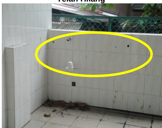
Gambar 5.8 Paip Air Dan Singki Yang Dipasang Telah Hilang
