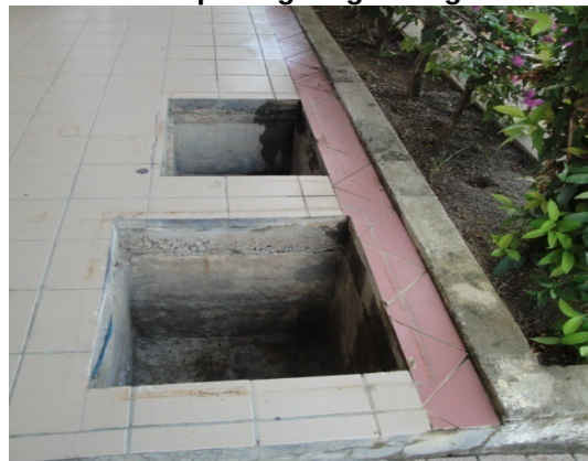
Gambar 5.23 Penutup Longkang Hilang
