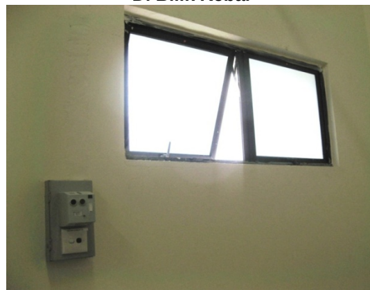
Gambar 2.11 Penghadang/ Grill Yang Tidak Dipasang Di Bilik Kebal
