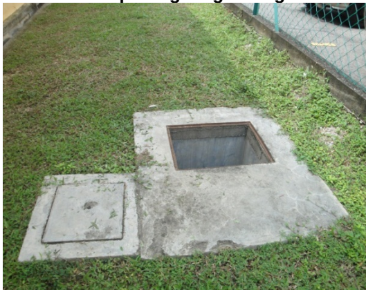
Gambar 5.15 Penutup Longkang Hilang
