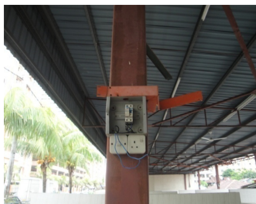
Gambar 5.11 Pendawaian Elektrik Telah Dirosakkan
