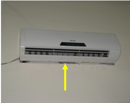
Gambar 2.8 Pemasangan Penyaman Udara Tidak Kemas Di Bilik Polis
