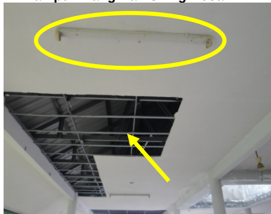
Gambar 5.25 Lampu Hilang Dan Siling Rosak
