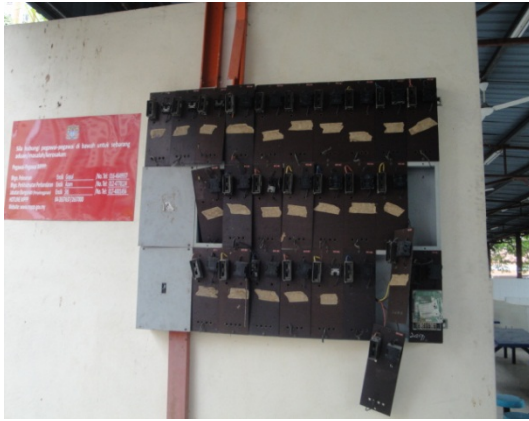
Gambar 5.12 Kotak Utama Suis Elektrik Yang Telah Dirosakkan
