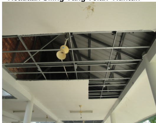
Gambar 5.29 Keadaan Siling Yang Telah Runtuh
