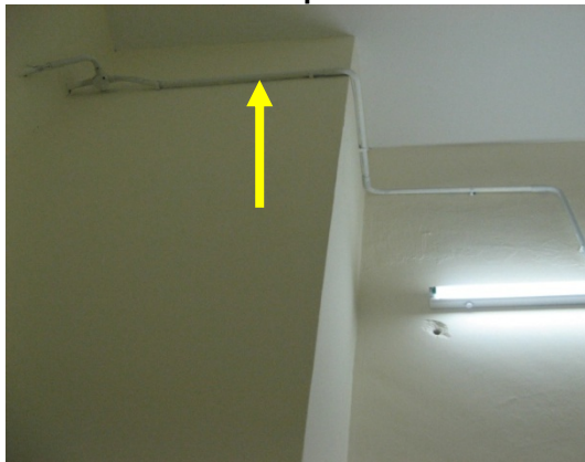
Gambar 2.12 Pendawaian Elektrik Tidak Dipasang Di Dalam Lepaan Simen
