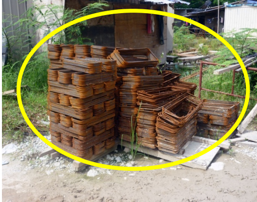
Gambar 13.12 Besi Yang Diletakkan Di Tempat Terbuka Tanpa Ditutup Dengan Sempurna
