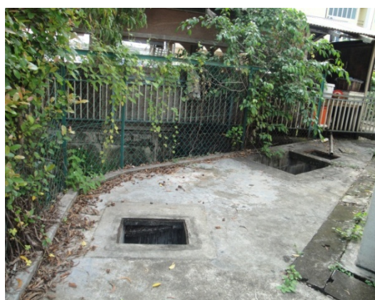
Gambar 5.9 Besi Penutup Longkang Telah Hilang
