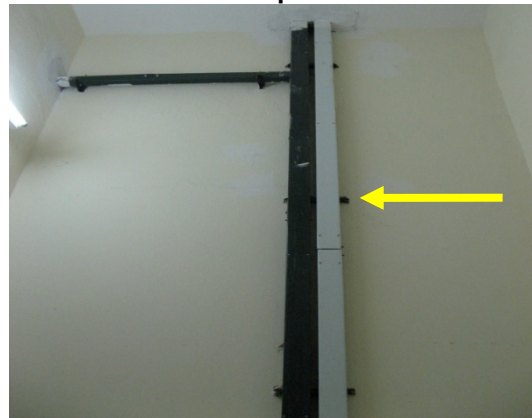
Gambar 2.13 Pendawaian Elektrik Tidak Dipasang Di Dalam Lepaan Simen
