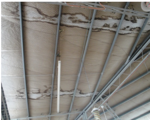
Gambar 5.19 Bumbung Kompleks Makanan Bocor
