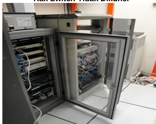
Gambar 3.4 Rak Switch Tidak Dikunci
