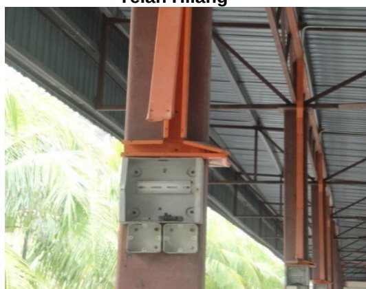
Gambar 5.10 Suis Dan Pendawaian Elektrik Telah Hilang
