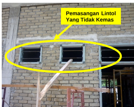
Gambar 13.6 Lintol Yang Dipasang Tidak Kemas
