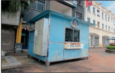
Jalan Rahmat Balai Polis tidak beroperasi dan terbiar (18.04.2023) (Sumber: Jabatan Audit Negara)
