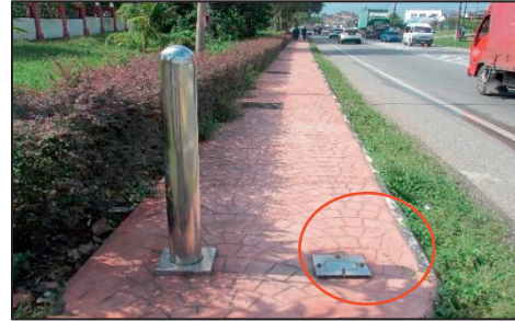
Tiang Bollard Stainless Steel /Tertanggal Jalan Pontian - Johor Bahru, Pekan Nenas, Pontian (19.06.2023) (Sumber: Jabatan Audit Negara)
