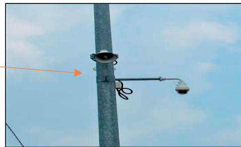
Taman Bukit Perdana Kamera CCTV yang dipasang tidak berfungsi (18.04.2023) (Sumber: Jabatan Audit Negara)
