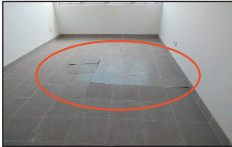
PPR Perling Rumah No. 9 Tingkat 6 Blok - Kerosakan Lantai (19.2.2023) (Sumber: Jabatan Audit Negara)
