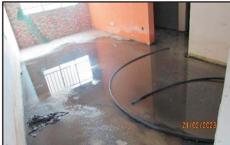
PPR Melana Indah Fasa I Rumah No. 13 Tingkat 1 Blok 6 - Manhole Tersumbat (21.2.2023) (Sumber: Jabatan Audit Negara)
