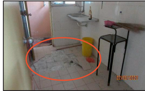
PPR Kempas Permai Rumah No. 7 Tingkat 5 Blok C - Kerosakan Lantai (22.2.2023) (Sumber: Jabatan Audit Negara)
