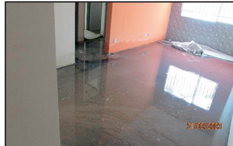
PPR Melana Indah Fasa I Rumah No. 26 Tingkat 1 Blok 6 - Manhole Tersumbat (21.2.2023) (Sumber: Jabatan Audit Negara)
