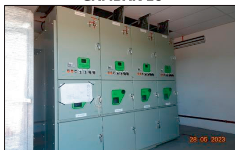
Tok Uban, Pasir Mas - Fasiliti elektrik yang telah siap dipasang (28.05.2023) (Sumber: Jabatan Audit Negara)
