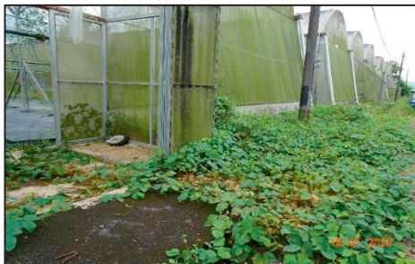
TKPM Batang Merbau, Tanah Merah - Penyenggaraan Kebersihan Tidak Dibuat (18.01.2023) (Sumber: Jabatan Audit Negara)
